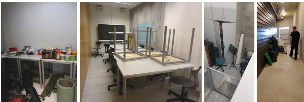
Bilder 24. Fra venstre: Uteskoleutstyr lagret på samtalerom i trinnareal. Lagring av bord og stoler på grupperom. Til høyre: Oppbevaring av utstyr og materiell i gangsoner og rømningsveier.
