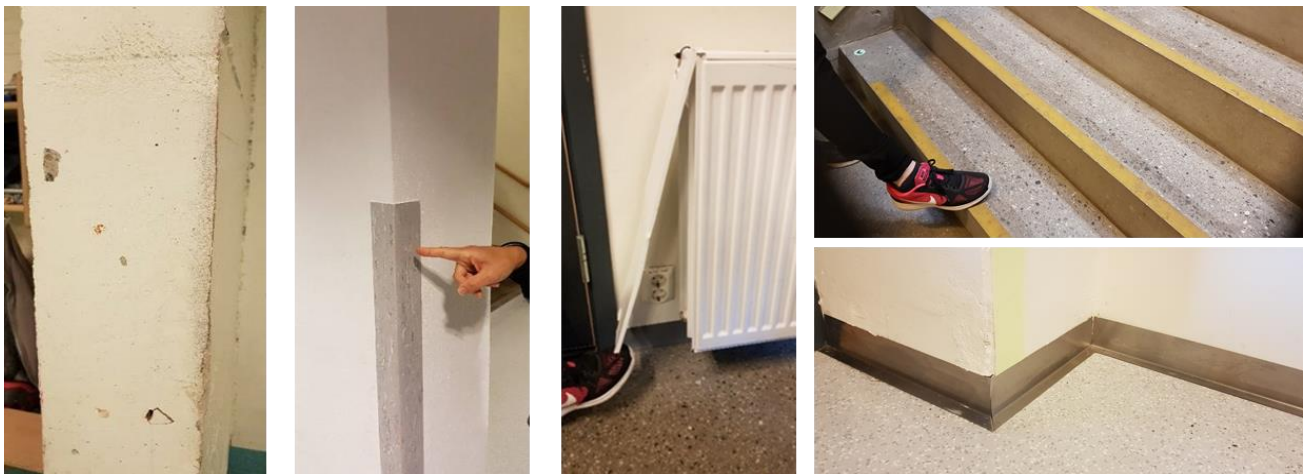
Bilder 5; Eksempler på tekniske løsninger med stort behov for vedlikehold
