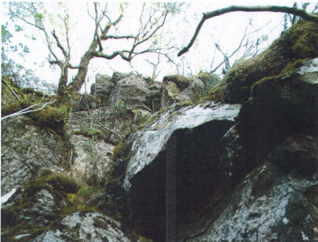
Bilde 5: Viser løse blokker i bergveggen.
