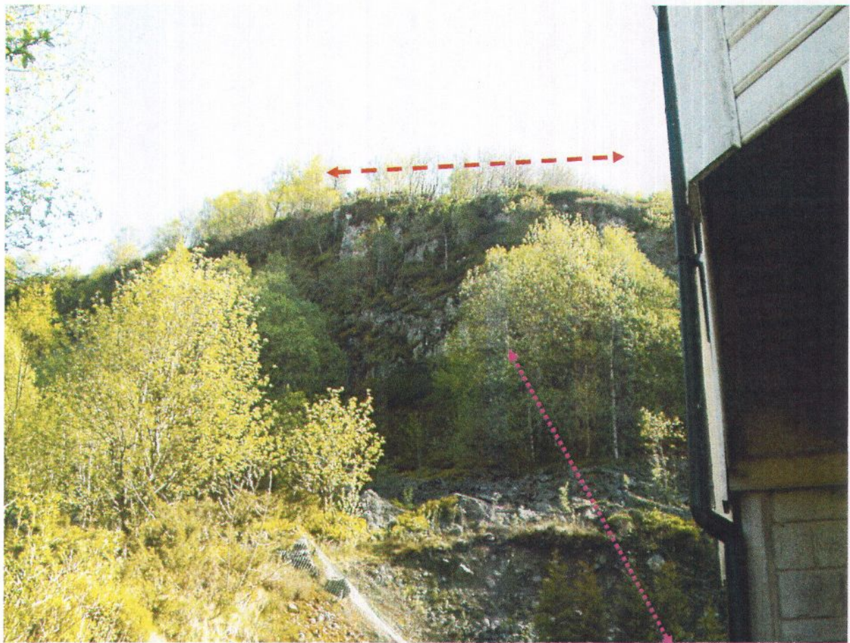
Bilde 1: Viser bergpartiet og ura. Det er gjort betydelige inngrep i foten av ura uten at løsmassene her i etterkant er blitt sikret. Bergpartiet hvor det er observert løse blokker er merket med rødstiplot linje, og profilet som framkommer på figurene 2 og 3 er markert med lilla prikkstiplot linje.
