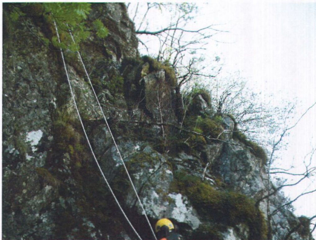
Bilde 3: Viser løse blokker i bergveggen.
