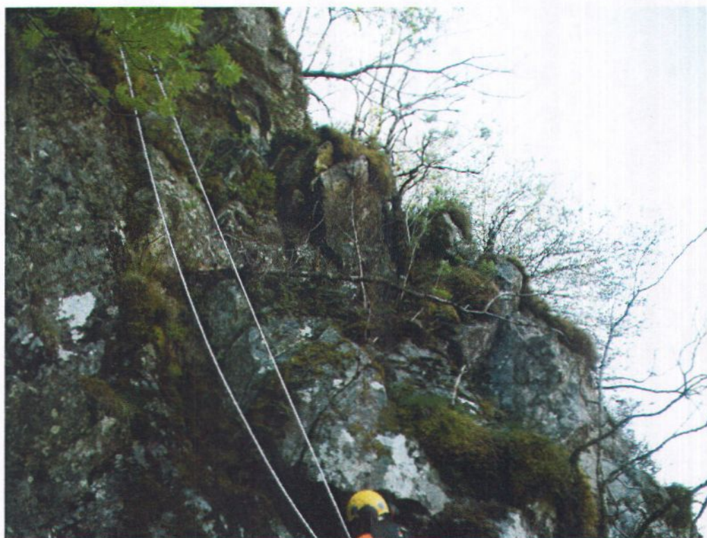
Bilde 3: Viser løse blokker i bergveggen.
