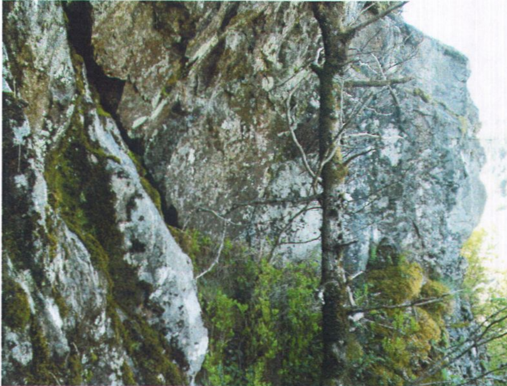
Bilde 4: Viser blokk i bergveggen som det er tegn til bevegelse i.
