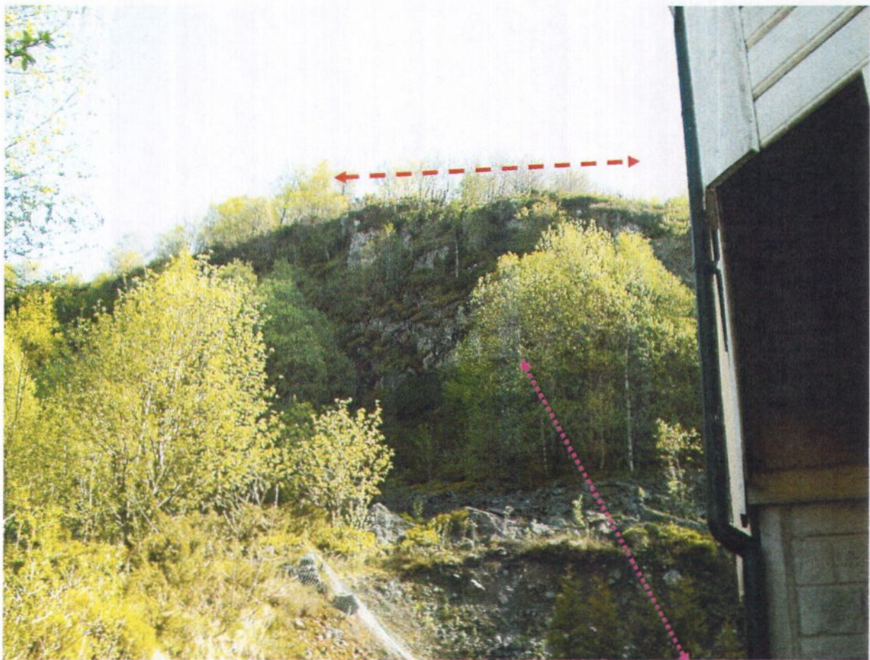
Bilde 1: Viser bergpartiet og ura. Det er gjort betydelige inngrep i foten av ura uten at løsmassene her i etterkant er blitt sikret. Bergpartiet hvor det er observert løse blokker er merket med rødstiplot linje, og profilet som framkommer på figurene 2 og 3 er markert med lilla prikkstiplot linje.
