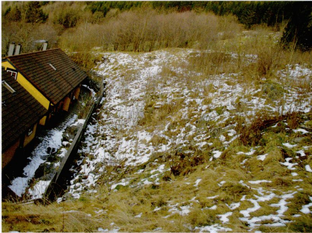
Bilde 1: Teigane 52-60, nr. 60 nærmest. Tatt mot nord. Dyrket mark i bakgrunnen. En del blokker fra tidligere steinsprang ligger i terrenget. Lav betongmur med liten grøft bak husrekka.
