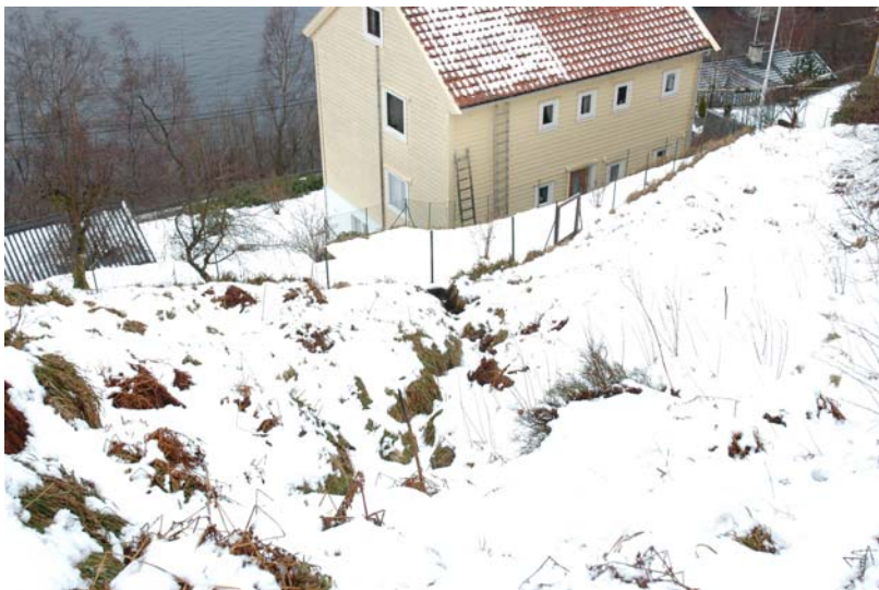
Foto: Løsmasseskråning ved Tellevikveien 81.
