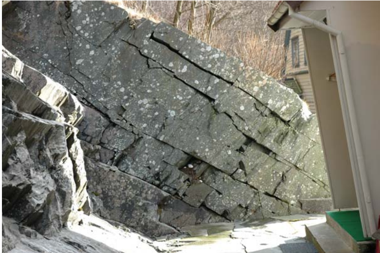
Foto: Oppsprukket fjell ved Natlandsveien 98B.
