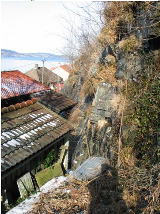
Foto: Skanselien 9B. Løse blokker sees øverst til høyre.
