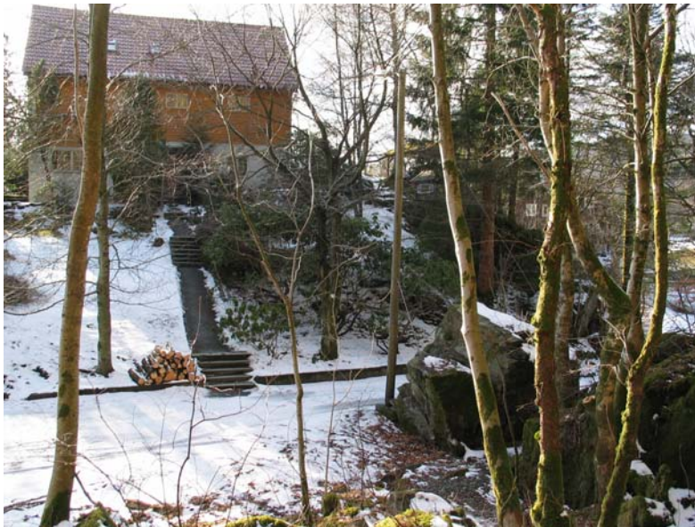
Foto: Myravegen. Steinsprangblokker ligger helt ned til veggen og garasjen
