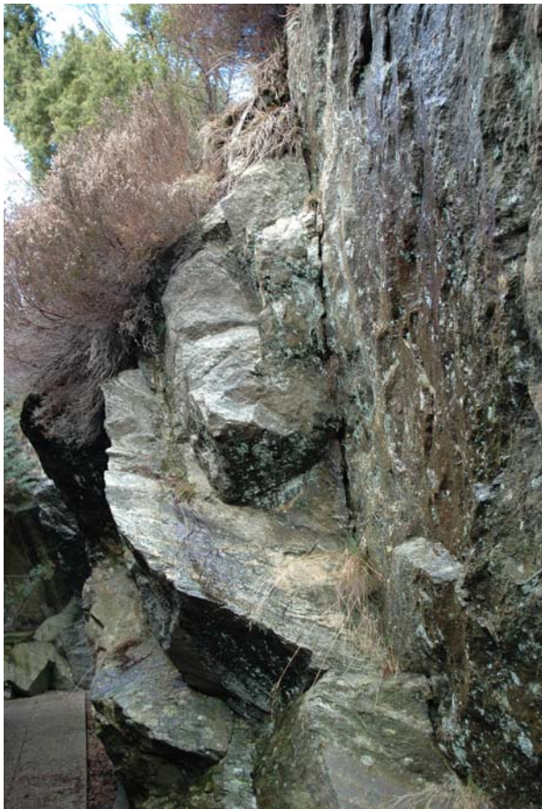
Foto: Oppsprekking i fjellskrenten ved Djupedalen 21.
