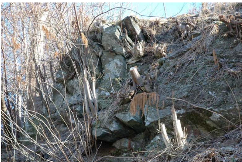
Foto: Oppsprukket fjell ved Statminister Michelsensvei 69B
