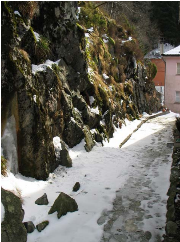
Foto: Blokkfall (steinsprang) bak hus Breistølen 36.
