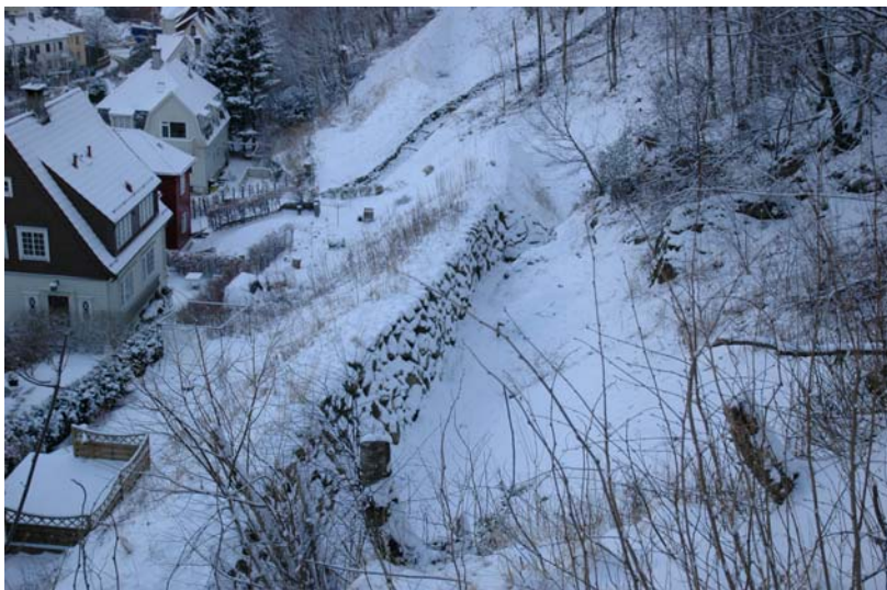
Foto: Sikringene med voll for Bjørndalen 42-36
