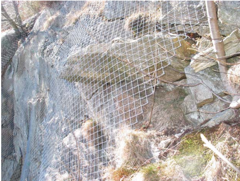
Foto: Ullsmågvegen 47. Løse blokker sitter bak nett.
