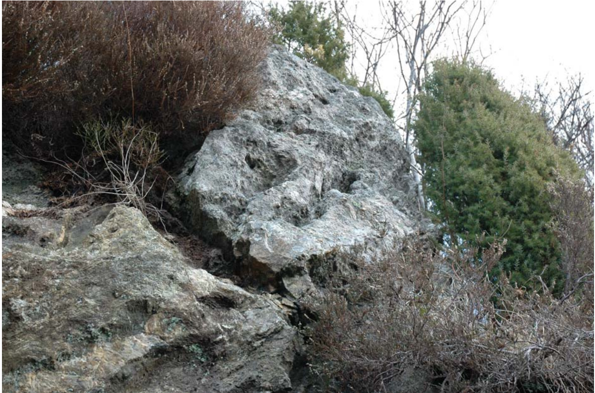
Foto: Løs blokk ved Djupedalen 21.
