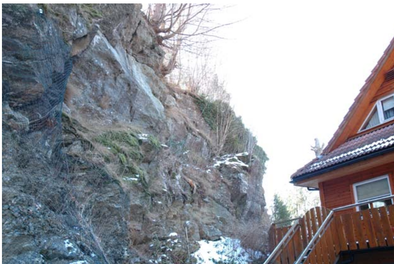
Foto: Bratt fjellskrent med oppsprukket fjell ved Ny Paradis 84
