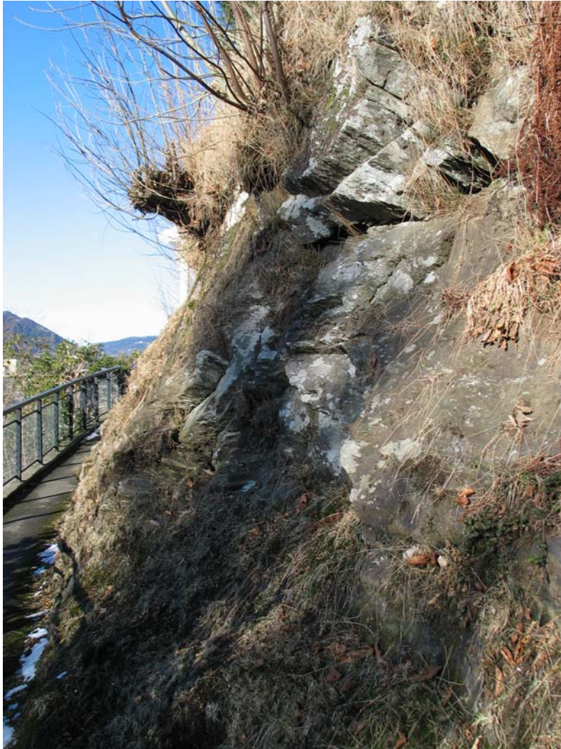
Foto: Fra området mellom Kloppedalsvegen 4 og Hop Terrasse. Svært løst og forvitret fjell.
