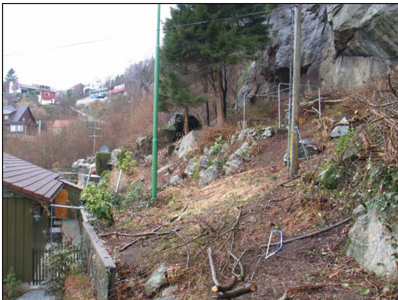
Foto: Fjellveggen bak Eikeviken 49 er oppsprukket og blokkfall sees. I bakgrunnen ligger blokker på flere m 3 . Foto BAF.
