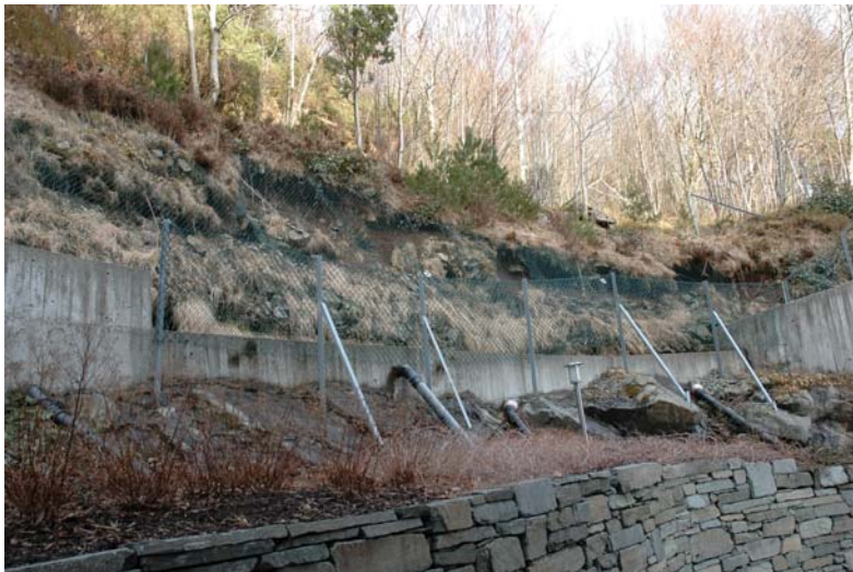
Foto: Nedre del av skråningen ved Morvikbotn 280.
