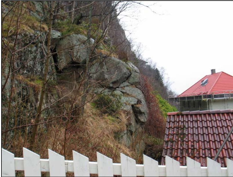
Foto: Fjellveggen bak Solbakksvingen 1 er oppsprukket. Blokkfall sees langs hele fjellsiden oppover til nr 11. Foto BAF.
