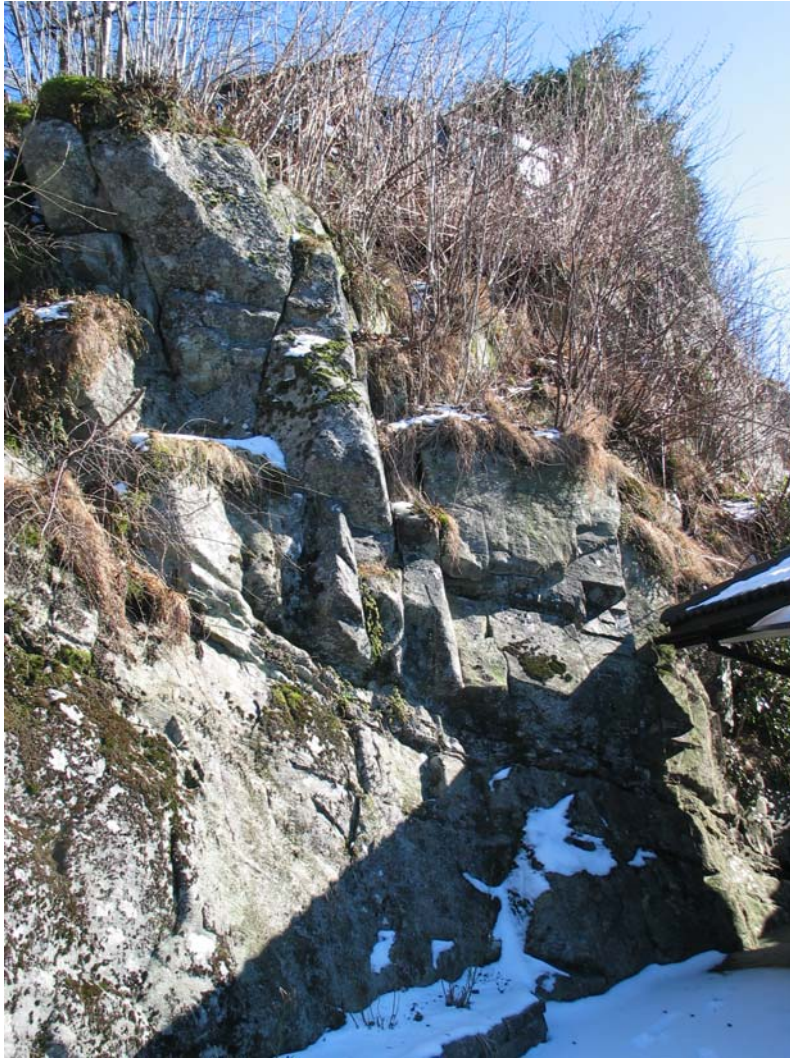
Foto: Hovdenvegen 7. Høg skjæring med tilsynelatende løs stein nær boligen.
