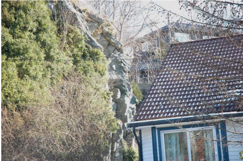
Foto: Fjellskrent ved Storetveitveien 174.
