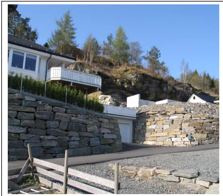
Foto: Fjellveg med manglende sikringsarbeider i ny utskutt tomt.
