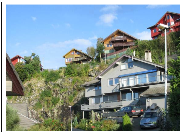
Foto: Fjellsiden bak Fanakrå 24 med støttemur mot overliggende veg. Noe løst fjell sees.
