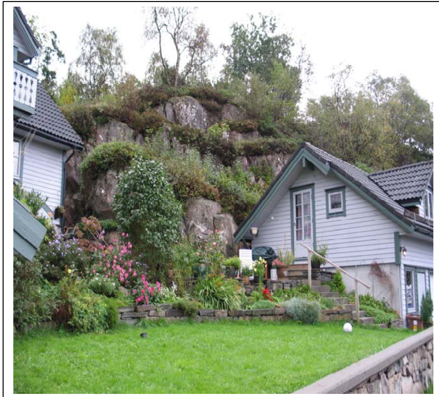
Foto: Buskavegen 40 er anlagt helt inn til fjellveggen. Noe løst fjell sees.
