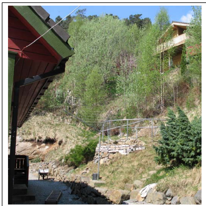
Foto: Forvittringsmateriale bak hus Gullstølslia 20-18.
