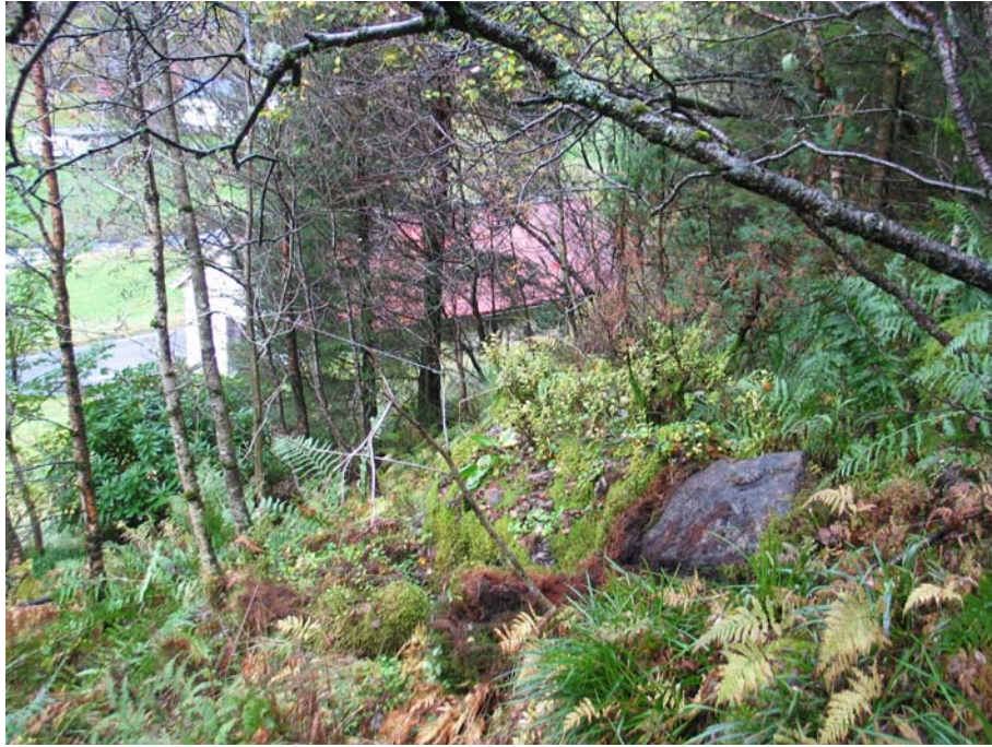
Foto: Ved Gullfjellveien 383. Enkelte mindre skrenter danner steinsprangblokk som ligger i skråningen helt ned mot huset.
