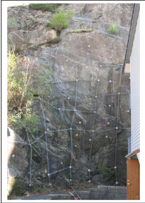
Foto: Fjellvegg med sikkerhetsnett bak hus Sælenveien 5.
