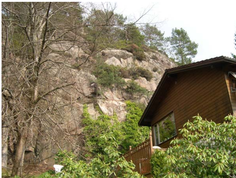
Foto: Spelhaugen 3, nordre hushjørne, med bergskrent som inneholder en del sprekker og hvor det har falt ned en del mindre stein bak huset.
