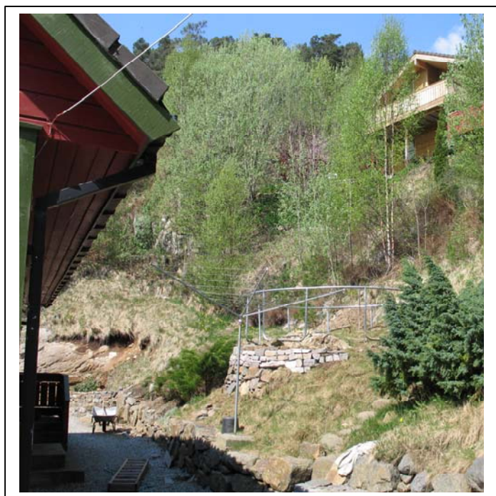
Foto: Forvittringsmateriale bak hus Gullstølslia 20-18.
