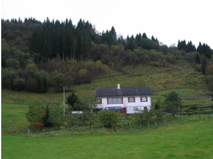
Foto: Løsmasser i bratt skråning bak Kalihaugen 110.
