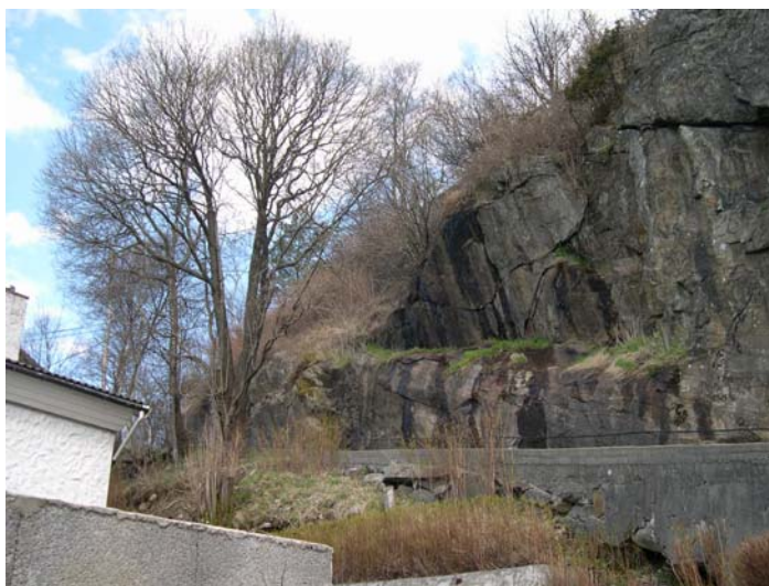
Foto: Bergvegg med sprekker og svakt overheng ovenfor Straumevegen 199.
