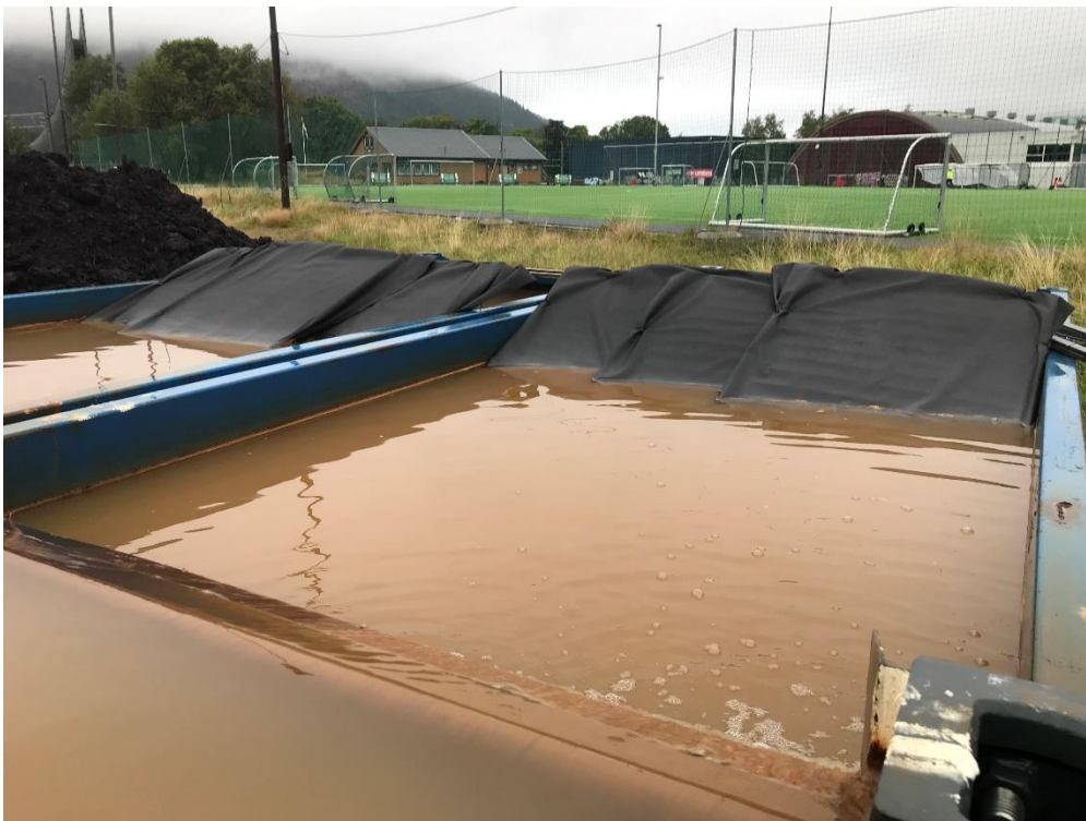
Figur 5 Bilde av duken som skal holde tilbake partikler ved sedimentasjonsbassengets utløp.
