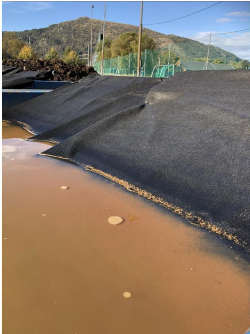
Figur 4: Filter i sedimentasjonskamrene. Tydelig sedimentering og utfelling av jern på overflaten av filteret.
