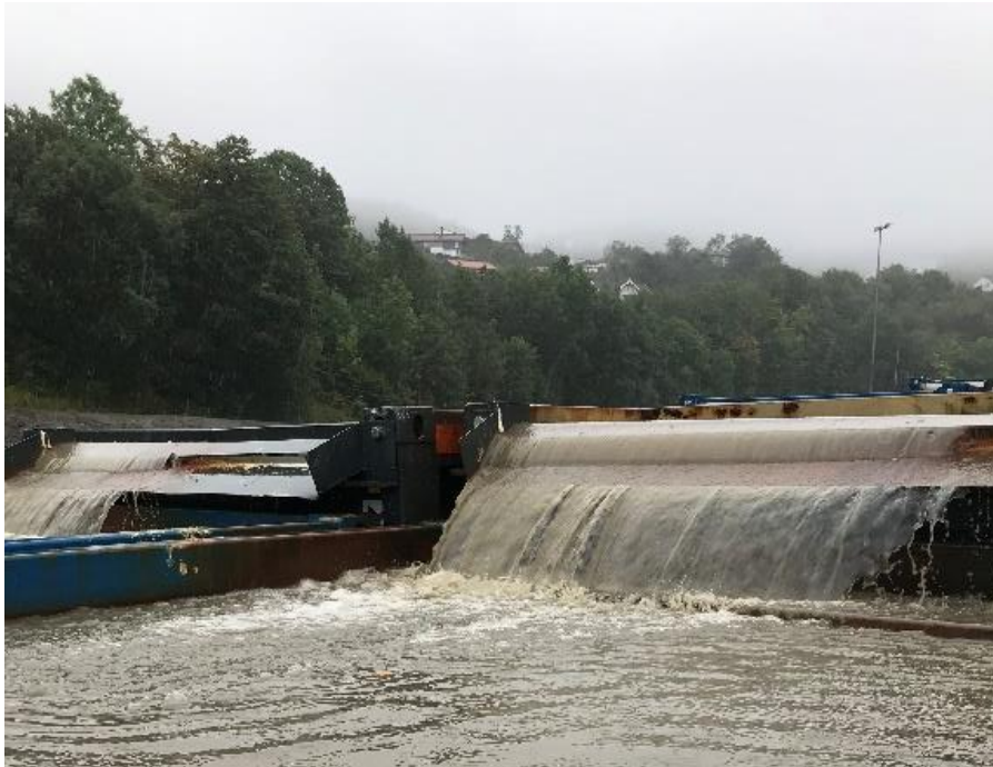
Figur 2 Unormalt høy vannføring i sedimentasjonsanlegget på Slettebakken.
