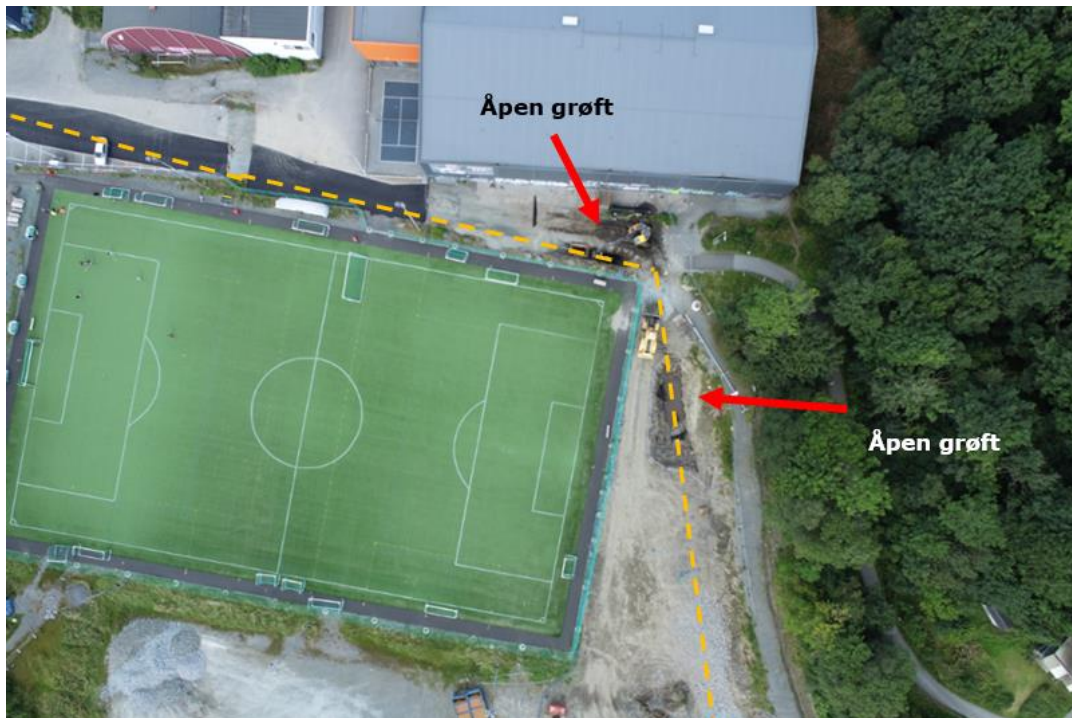
Figur 3: Dronefoto av området rundt kunstgressbanen. Omtrentlig plassering av overvannsledning er vist med stiptet linje. Røde piler viser hvor rørene ikke var koblet til og grøftene stod åpne.
