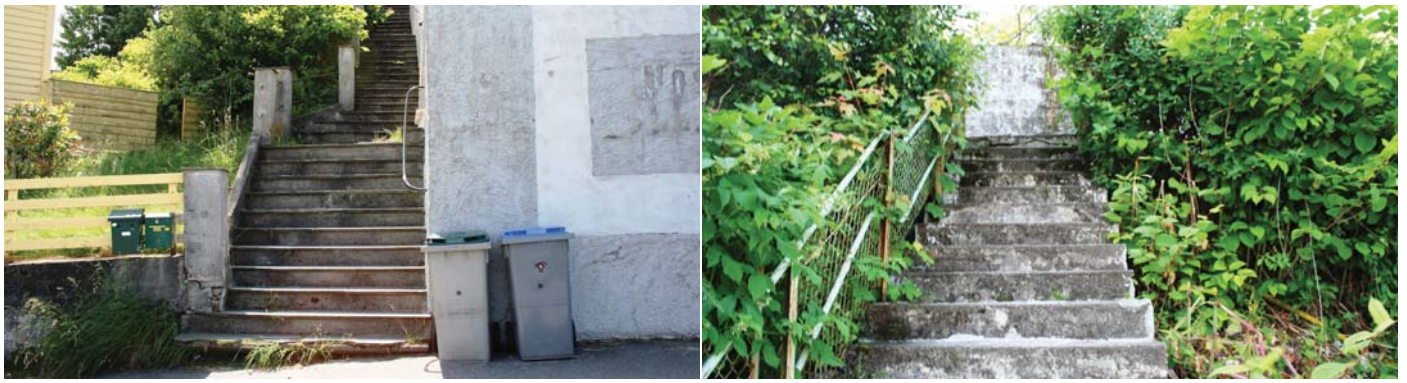
Over: Snarvei /trapp fra svingen i Øvre Stadionvei((17) til Damsgårdslie, som er en del av skoleveien til Damsgård skole. Trappen er slitt, men ikke registrert som skummel/ farlig
