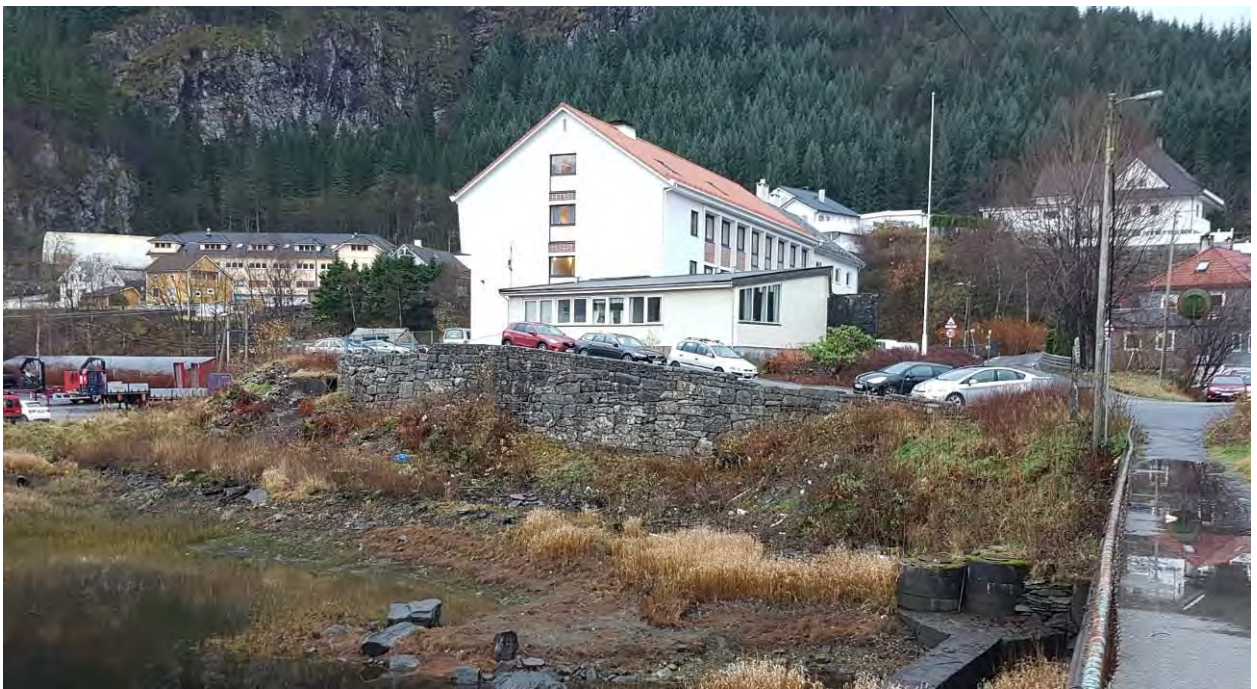
Figur 18: Del av gjenværende demningsmur mot kommunehuset i Eidsvåg (Foto: Byantikvaren 2018).
