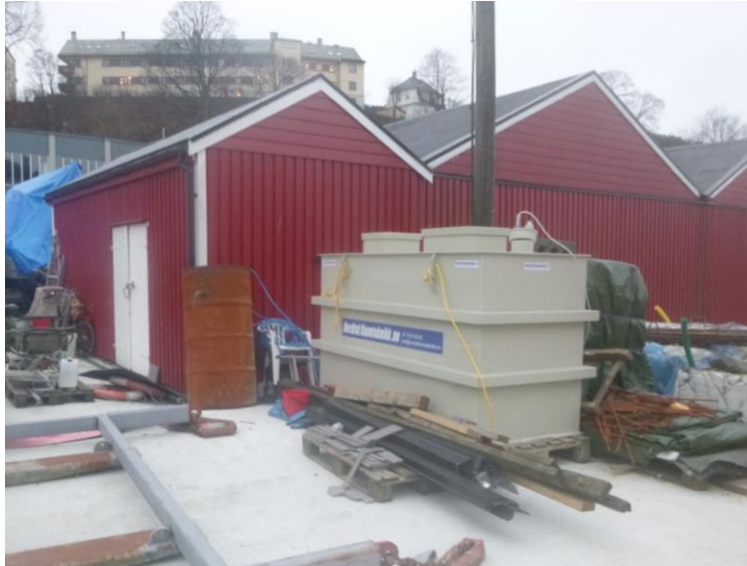
Figur 8 Sedimentasjonstanken som inngår i renseanlegget. Tanken skal plasseres innendørs etter oppkobling.
