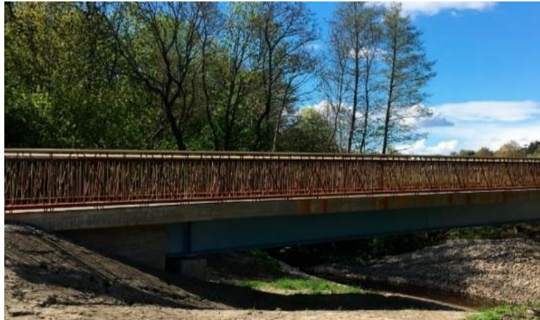
Figur 5-51: Eksempel på hvordan en stedstilpasset bro i naturområdet kan se ut. Formgivning ikke låst. Foto: Norconsult, 2018
