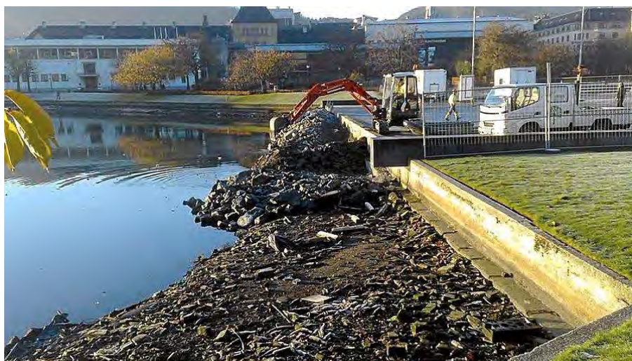
Figur 116: Sommeren 2009 kom Smålungerenes bunn-sedimenter til syne under arbeidene med trappen foran Festplassen, og stanken av forråtnelse kom også tilbake. Det ble ifølge kilder hos utførende entreprenør, Løvaas AS, fylt ut hele 3600 m 3 stein i vannet, for det viste seg å være langt dypere enn antatt (anslaget før igangsetting var 3-400 m 3 ). Dybden ved foten av den nye fyllingen ble målt til hele 29 meter. Foto: Pål Vidar Engesæter, Bergens tidende
