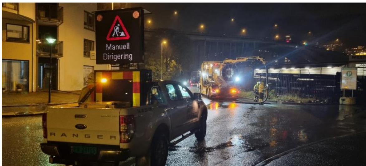
Figur 11 Bilder fra tømning av sandfang i kommunal vei på dagtid, Damsgårdsveien (Bydrift) og på nattestid i fylkesvei i sentrum, O.J.Brochs gate (Vitek).
