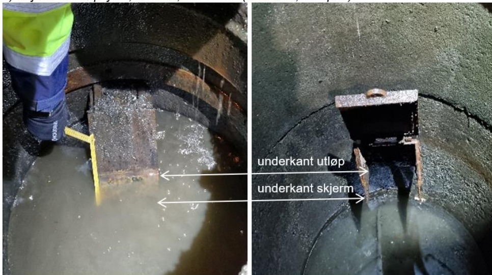
1) Skjerm av støpejern, kantete, ca. 10 cm (t.v.lukket, t.h.åpen)
