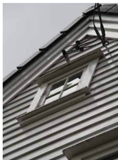
Gammelt vindu i lærerboligens fasade mot nord-øst.
