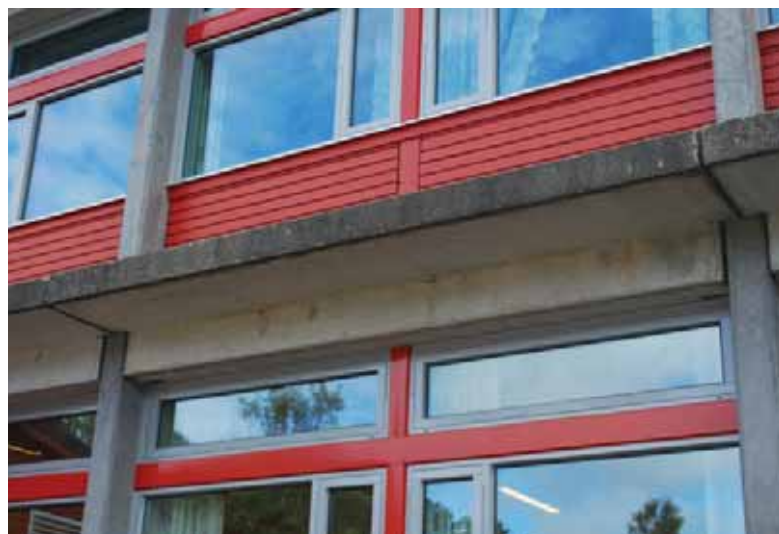
Elementbyggeri. Betongdekkene krager ut.
