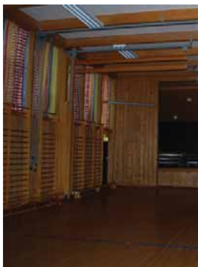
Gymastikksalen var på befaringsdato en karakteristisk gymsal fra 1960-årene.
