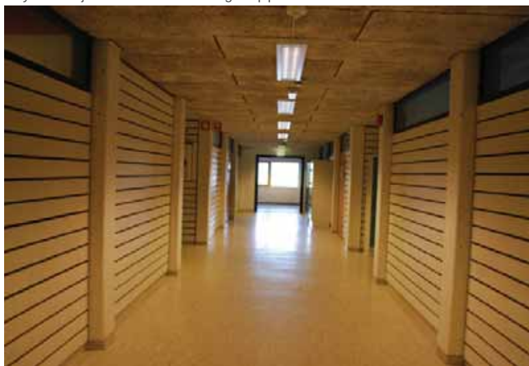
Konstruksjonen er synlig i korridorene. Overlys i lettveggene.
