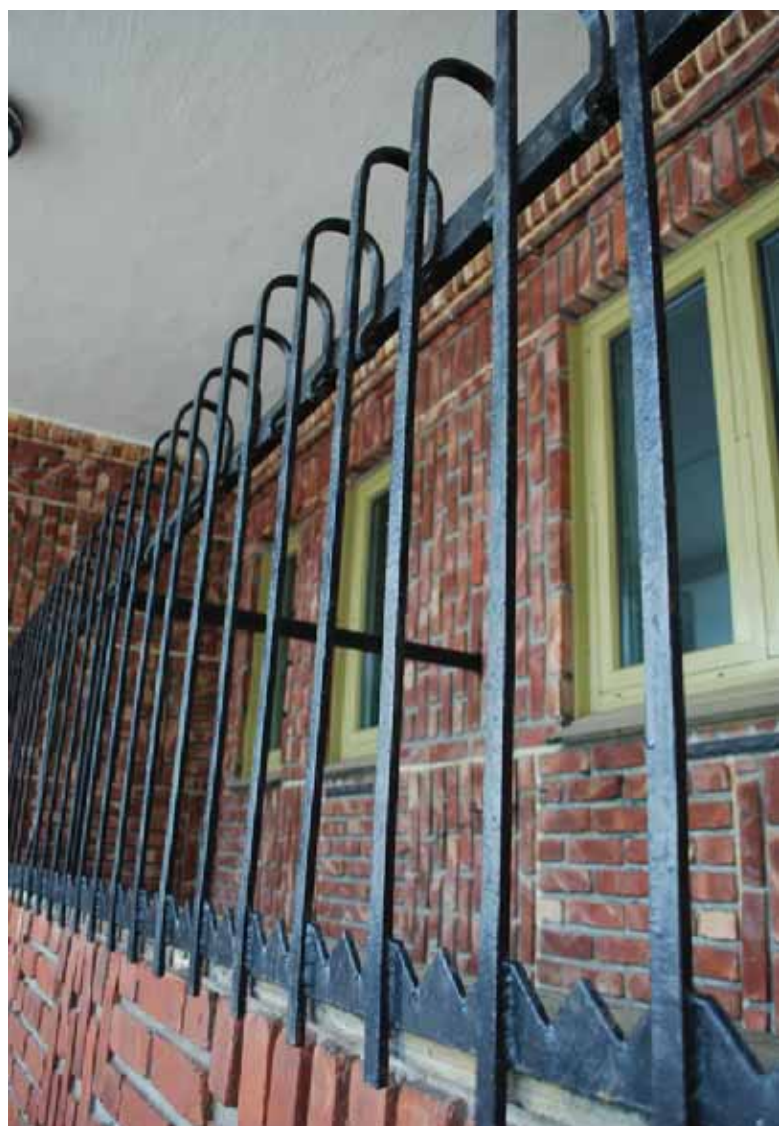
Smijersrekkverk i leskur (1952).
