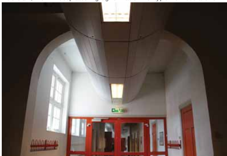
Ventilasjonsanlegg (nyere) i korridoren.
