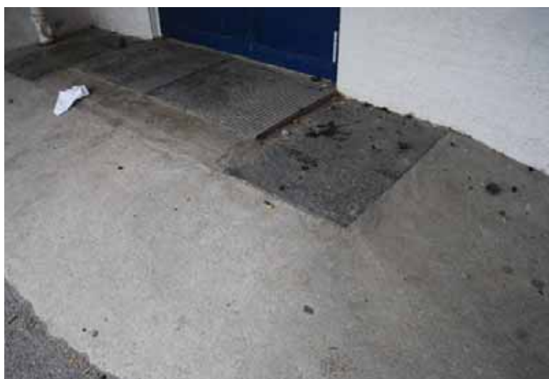
Opprinnelige trapper med skifer glattet ut med sement (U.U.).
