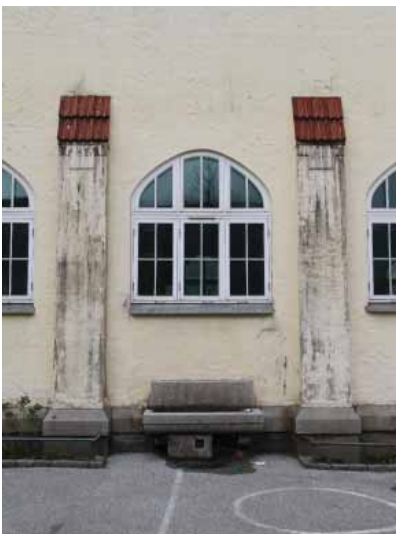
Buede vinduer og pilastere i nordfløy.
