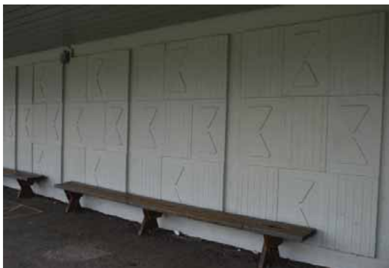
Relieff i betongveggen i uværsskuret (bygg A).
