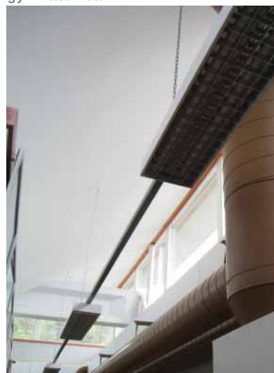
Overlys blir ført ned langs skrå himling. Eksponert ventilasjonssystem.
