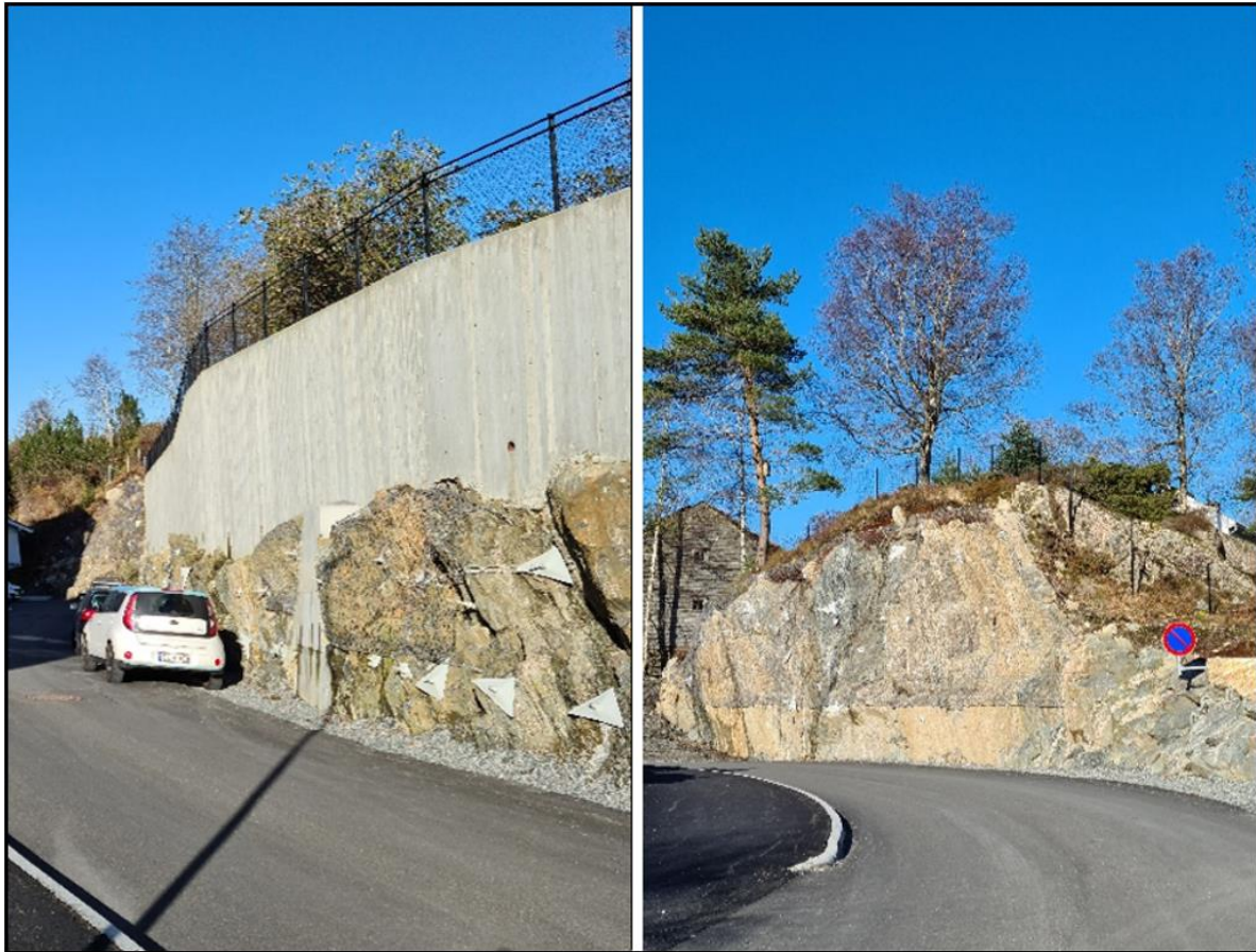
Figur 5-7: Bratte murer og fjellskjæringer i planområdet. Her sikret mur og sikret fjellskjæring langs ny tilkomstvei fra sør. Foto: Opus.
