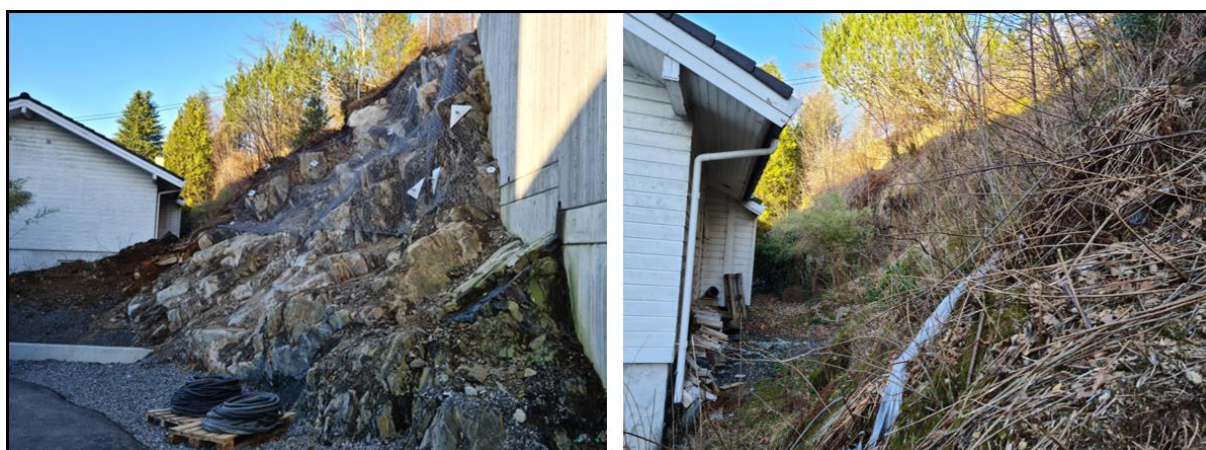
Figur 5-1: En skråning øst i planområdet har oppsprukket berg, og risikovurderes med tanke på mulig utglidning av masser. Foto 2021: Opus.
