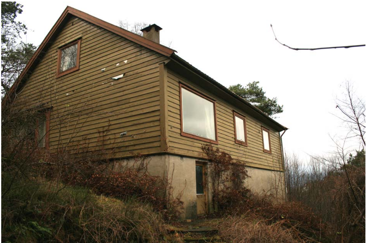
Enebolig på g/bnr 39/8. Søndre og østre fasade. Verandaen på tegningene er ikke etablert, mens det er etablert høyere kjelleretasje med inngangsdør i den østre fasaden.
