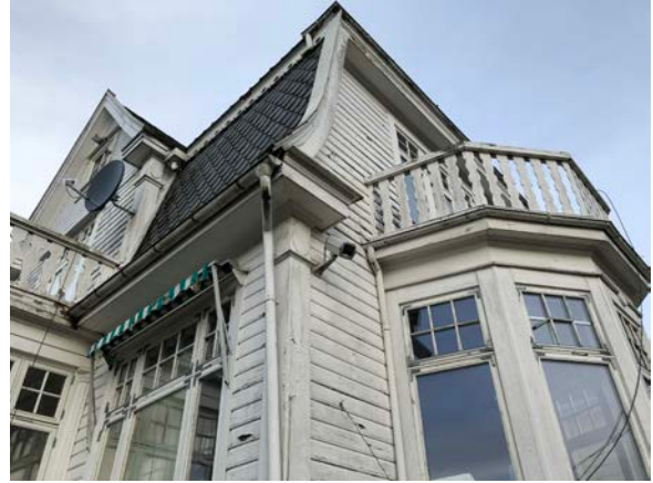
Figur 20 Fasaden mot vest er mest slitt av vær og vind. Tørrmur i hagen i forkant.
