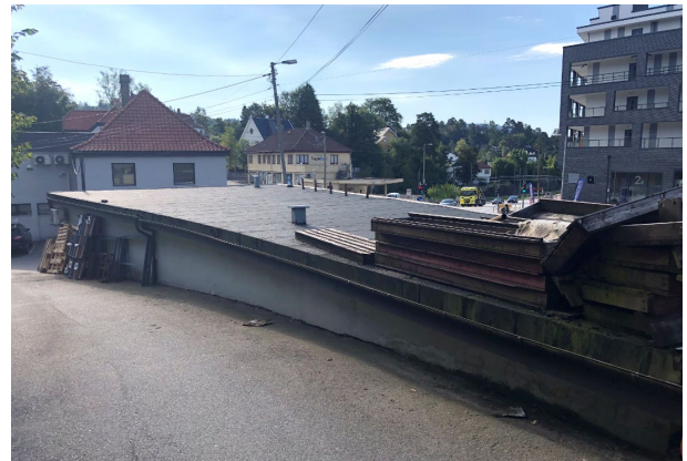
Figur 6-14 Bygget er buet i bakkant og delvis bygget inn i terrenget, sett mot øst.
