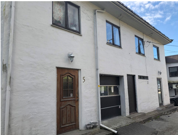
Figur 6-26 Det er vinduer og dører på bygget fra ulike tider. Garasjeporten er satt inn i nyere tid.
