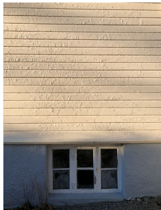
Figur 6-21 Nærbilde av østveggen der malingen tidligere har flasket av, men har blitt overmalt.
