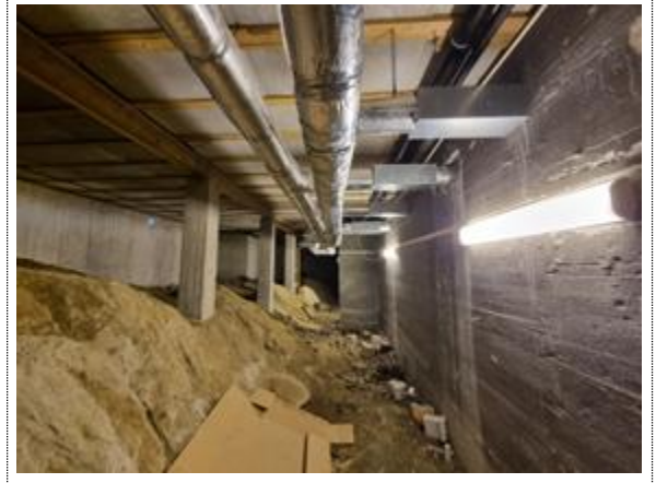
Bilde nr. 2.04 Venstre side: Grunnmur tilhørende baksiden av bygg 4. I midten: Betongsøyler Høyre side: Kjellervegg inn mot innredet U-etg. Kjellerveggen er ikke isolert.
