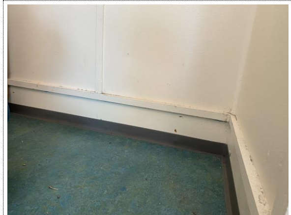
Bilde nr. 2.22 Gipsvegg med hard plate, antatt av eternitt på bunn som sparkelist.
