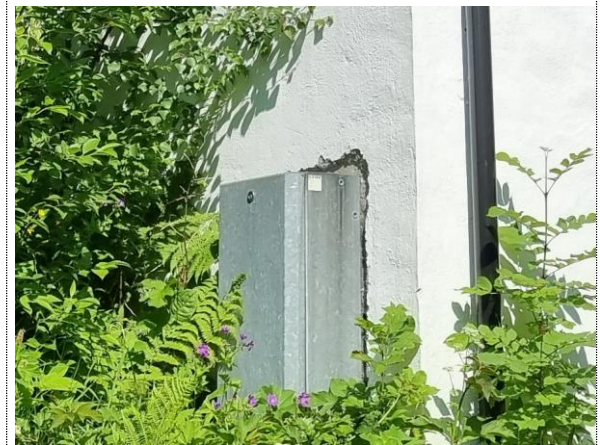
Bilde nr. 2.02 Nærbilde av teknisk skap, murpussen er påført rundt skapet. Dette antyder at murpussen er påført i etterkant av byggeår.
