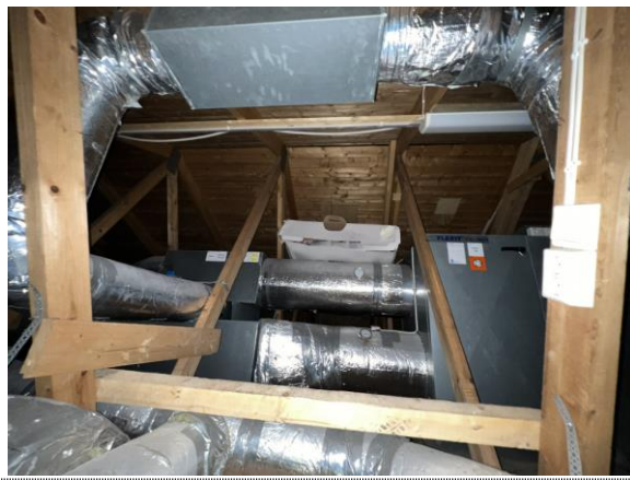
Bilde nr. 3.05 Aggregat og rørføringer til balansert ventilasjon.
