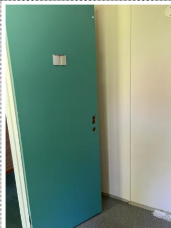
Bilde nr. 2.29 Laminert innerdør, mangler dørhåndtak.
