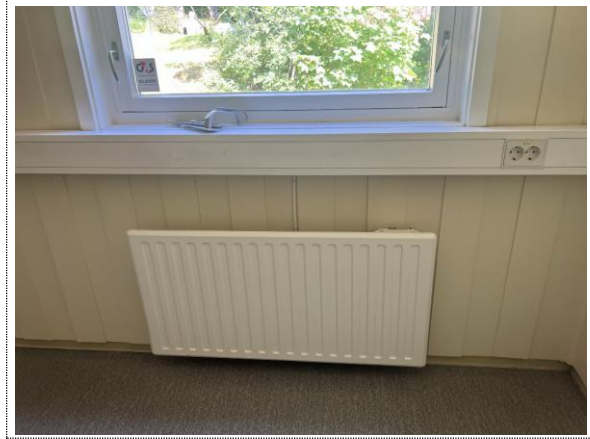
Bilde nr. 4.01 Varmeinstallasjon, panelovn.
