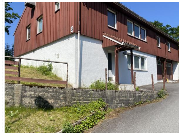
Bilde nr. 7.03 Området foran bygget. Støttemur i betong og defekt gjerde.
