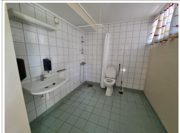
Bilde nr. 2.36 Gulvoverflate av fliser, misfargede fuger i våtsone. Himling av gips.
