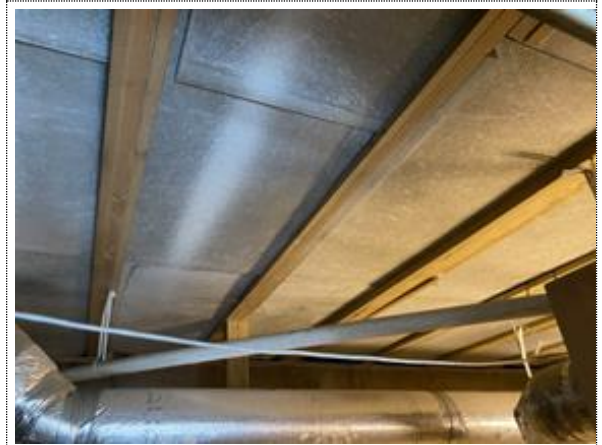
Bilde nr. 2.30 Synlige eternittplater i underkant av etasjeskiller mellom U.etg og 1.etg.
