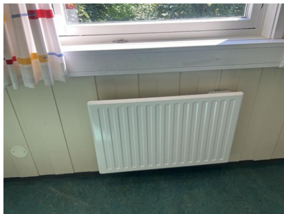
Bilde nr. 3.03 Varmeinstallasjon, panelovn.
