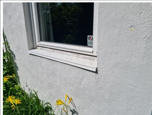
Bilde nr. 2.17 Mønlingsavskalling i karm under nyere vindu fra 2010. Vannbrettbeslag i metall, montert uten tilstrekkelig fall.
