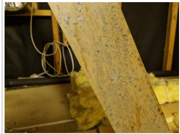
Bilde nr. 2.42 Begroing eller søl på takstol.
