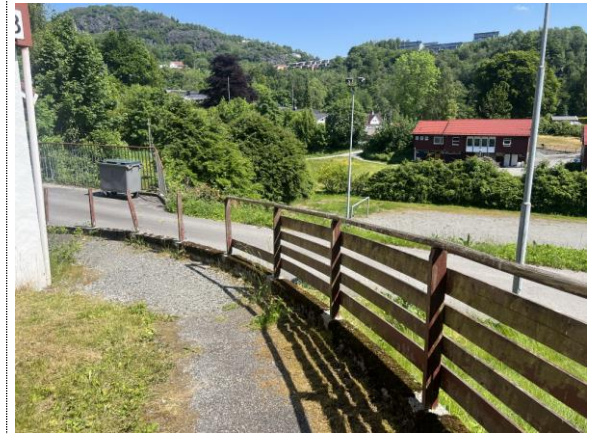
Bilde nr. 7.01 Defekt gjerde utenfor bygget.
