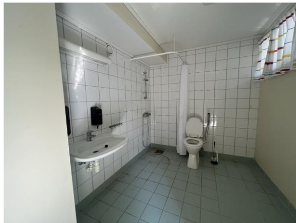
Bilde nr. 3.01 Sanitærinstallasjoner
