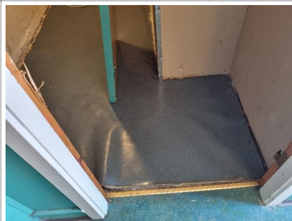
Bilde nr. 2.33 Gulvoverflate av banebelegg har løsnet på lagerrom i U.etg.
