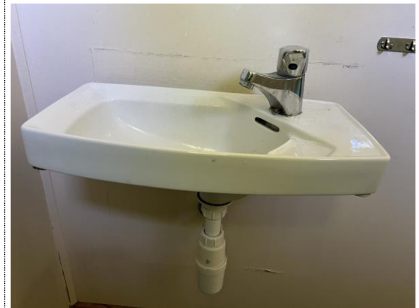
Bilde nr. 3.02 Nærbilde av sanitærinstallasjon, servant.
