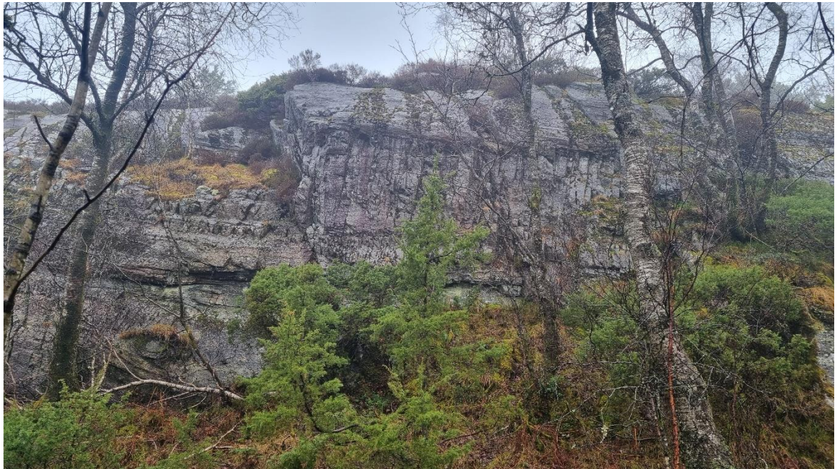
Figur 2: Deler av bergskråning hvor det er aktuelt med rensk, spredte kamstålbolter og muligens steinsprangnett. Bildet er tatt mot nordvest innenfor eksisterende hensynssone H301, i overgangen mellom område regulert til friområde og boligbebyggelse.
