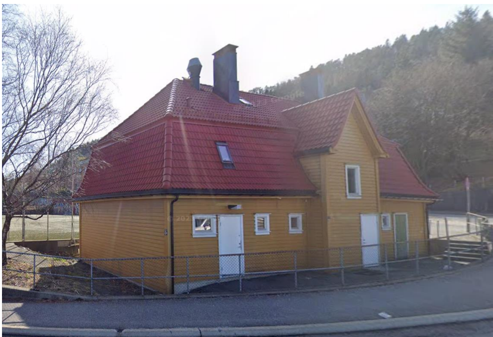
Figur 1-3 Lien 85 (Gyldenprisveien). Opprinnelig dobbelt så langt med to arker på hver side. Foto Google Map.
