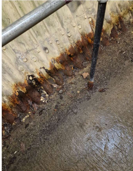
Figur 104: Korrosjon i bunn kulvert
