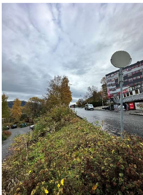
Figur 33: Bratte skråninger på nordsiden av vegen ned mot parkeringsplassen
