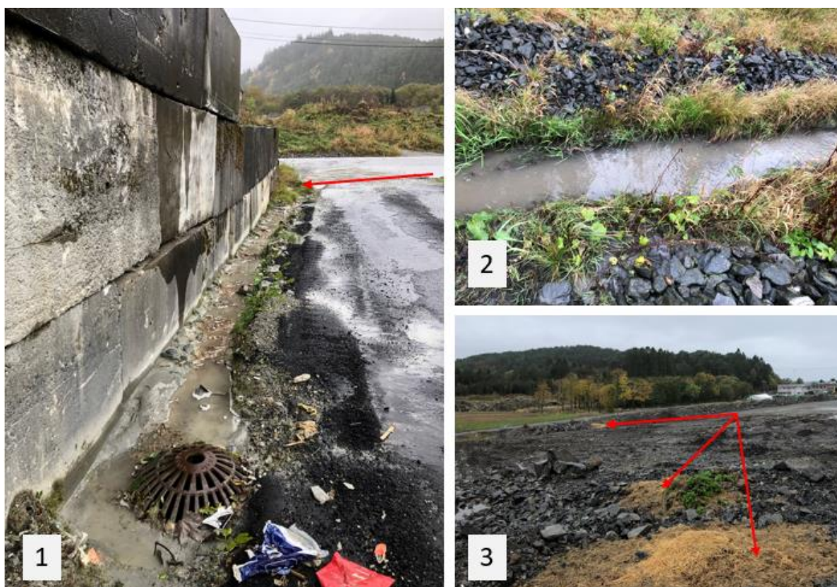
Figur 6-6: utfordringer med overvann. 1; Avrenning fra betongblanderi, og muligvis fra Norscrap West. Når det regner mye tar ikke kummer unna, og vannet renner videre til terrenget. 2; Overvann i ny grøft som går i kanten på deponiområde F Gardkjellermyr og 3; hestemøkk dumpet på Magnusstykket.
