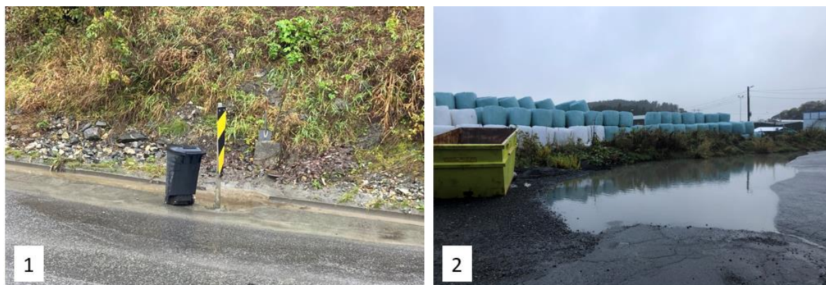
Figur 6-5: Ved internvegen i industriområdet. 1; Kummen som oftest går tett. Her står spade og bosspann klart. Ved mye nedbør renner vannet over veien til 2; stor dam og areal med grusdekke.
