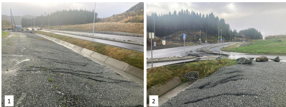
Figur 6-4: Bildene viser ny OV-grøft langs Skeivegen. Overvann fra deponisiden drenerer gjennom subb, og renner i subben viser at overvannet graver seg ned på undersiden av nytt OV-system. 1: Skeivegen fra kryss mot Stavollen og sør mot Pålamyra pumpestasjon. 2: Ved kryss mot Stavollen. Blakket overvann kommer inn på overvannssystem fra øst. Foto er tatt mot nord.
