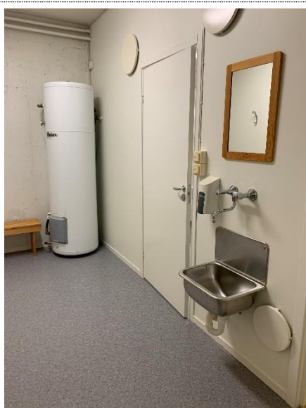
Bilde nr. 3.07 Varmtvannsbereider dusjanlegg
