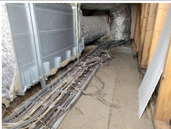
Bilde nr. 3.15 Luftbehandlingsanlegg blokk C og D
