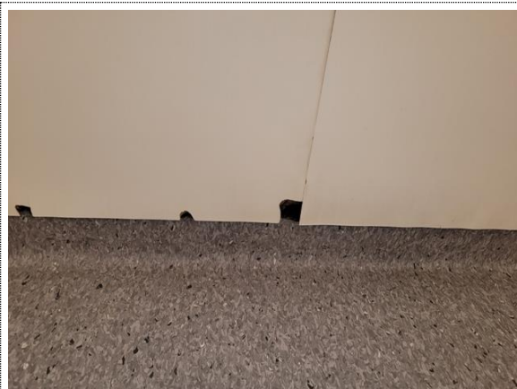
Bilde nr. 2.44 Innervegger dusj med skade på baderomsplater
