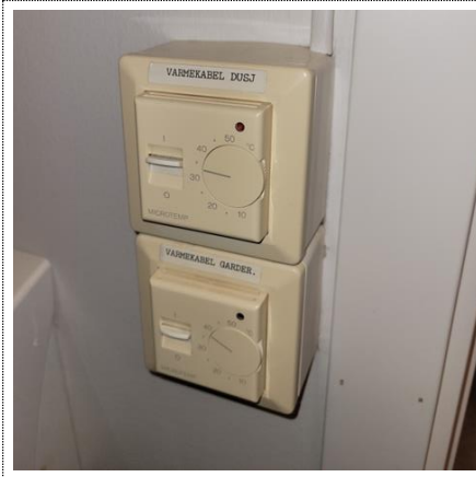
Bilde nr. 4.10 Varmekabel dusj og garderobe
