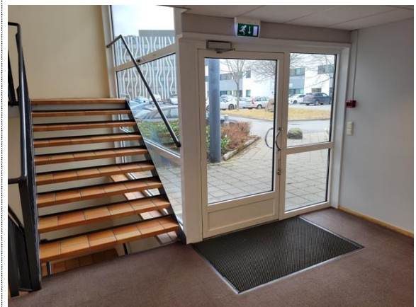
Bilde nr. 4.08 Nødløststyr
