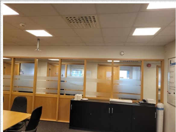
Bilde nr. 3.17 Tilluft i møterom
