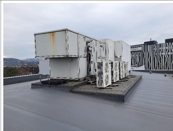
Bilde nr. 3.16 Luftbehandlingsanlegg blokk E og F
