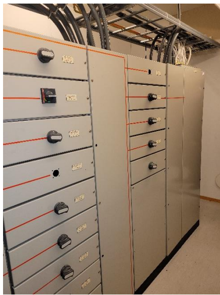
Bilde nr. 4.05 Hovedfordeling med underfordeling
