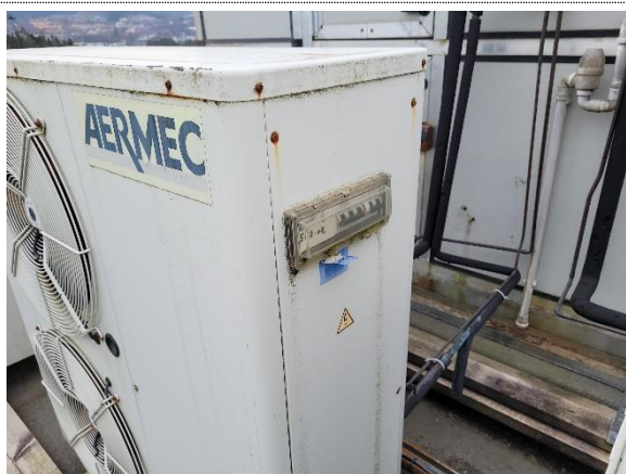
Bilde nr. 3.13 Luftbehandlingsanlegg blokk C og D
