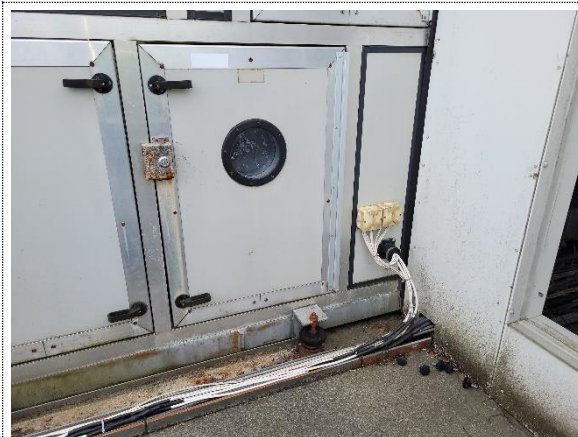
Bilde nr. 3.14 Luftbehandlingsanlegg blokk C og D
