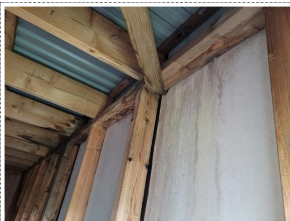
Bilde nr. 2.24 Synlig fuktpåvirkning på bindingsverk og takbjelker i teknisk rom på tak
