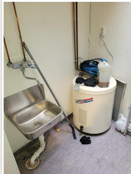
Bilde nr. 3.04 Utslagsvask og varmtvannsbereider
