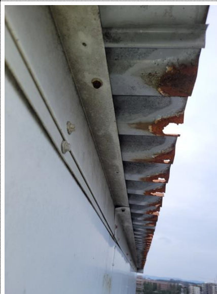
Bilde nr. 2.64 Korrosjonskader takplater på teknisk rom på tak
