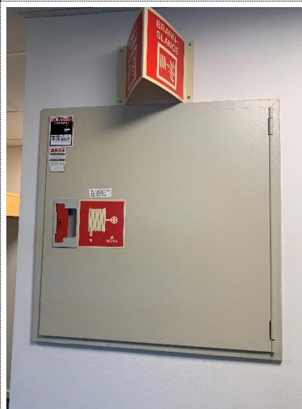
Bilde nr. 3.10 Brannslange
