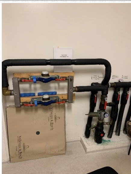
Bilde nr. 3.09 Stoppekraner og vannmåler
