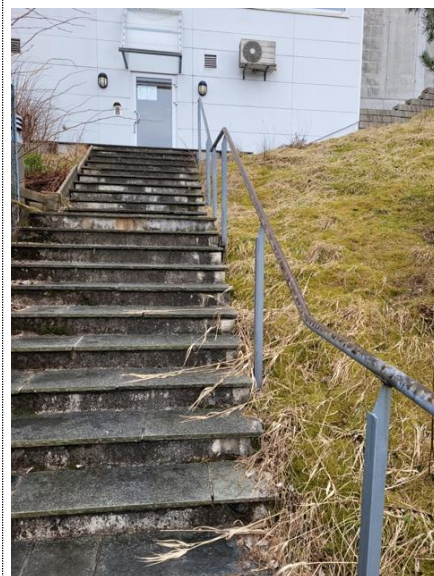
Bilde nr. 7.10 Utvendig støpt trapp belagt med stein. Korrodert stålrekkverk
