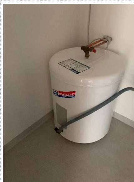
Bilde nr. 3.08 Mindre varmtvannsbereider kontorlokaler
