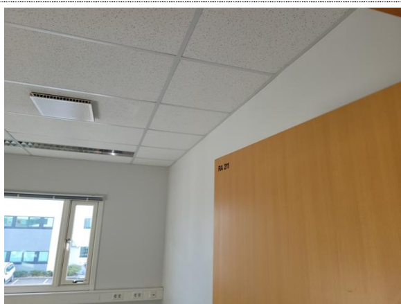
Bilde nr. 2.51 Systemhimling bygg A
