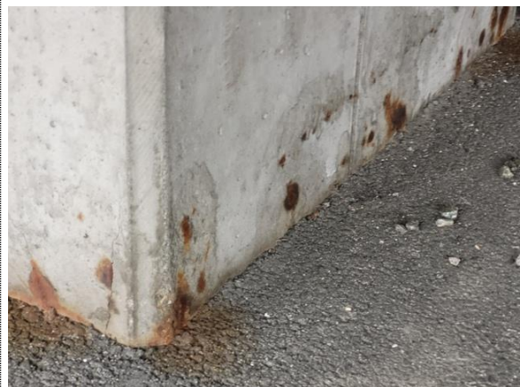
Bilde nr. 2.10 Armeringskorrosjon på betongsøyle i overgang mot bakken
