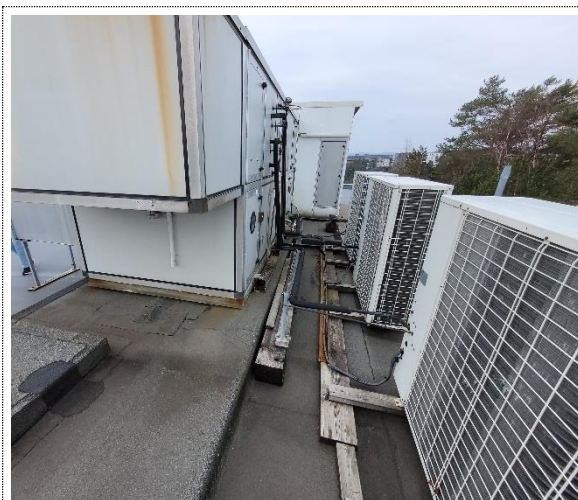
Bilde nr. 3.12 Luftbehandlingsanlegg blokk C og D
