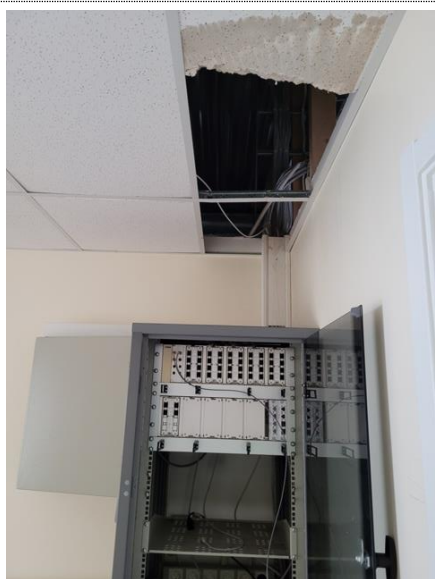
Bilde nr. 2.53 Systemhimling med fuktmerker i Bygg E
