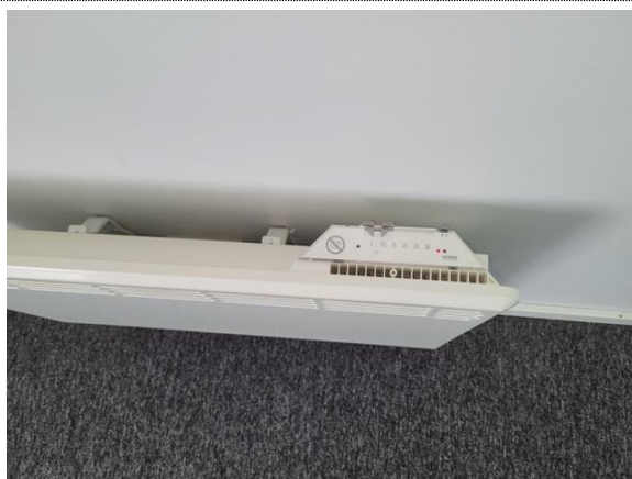
Bilde nr. 4.09 Varmeanlegg kontorer
