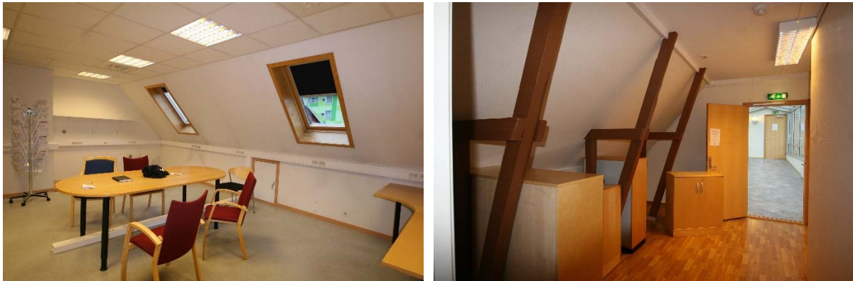
Til venstre andre etasje, nordre del. Nye takvinduer er satt inn. Til høyre foto mot den glassoverbygde gangbroen. Knebukkene er her ikke bygd inn, men er bevart som synlige elementer.
