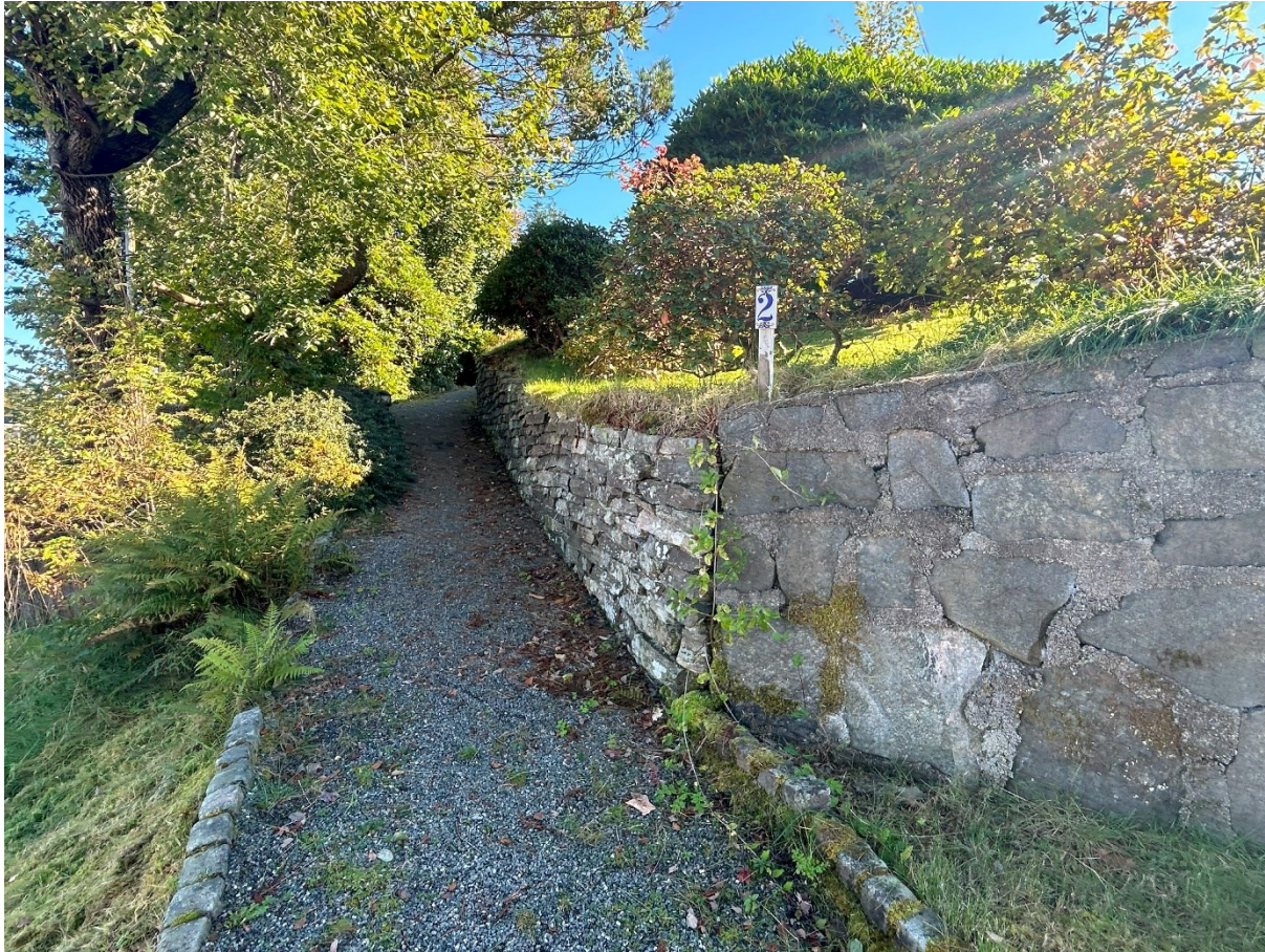
Støttemur fortsetter inn til eldre gangtilkomst og intern støttemur mot plen og mulig tilfylling langs kjeller etg.
