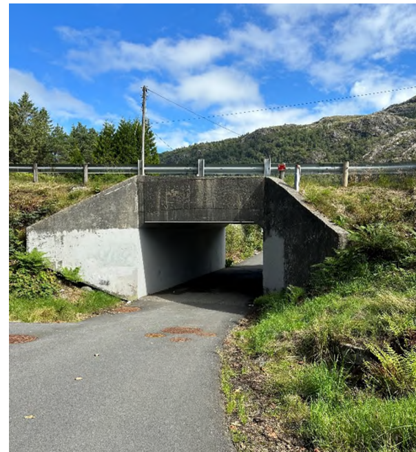
Figur 31: Kulverten som går under Olsvikskjenet.
