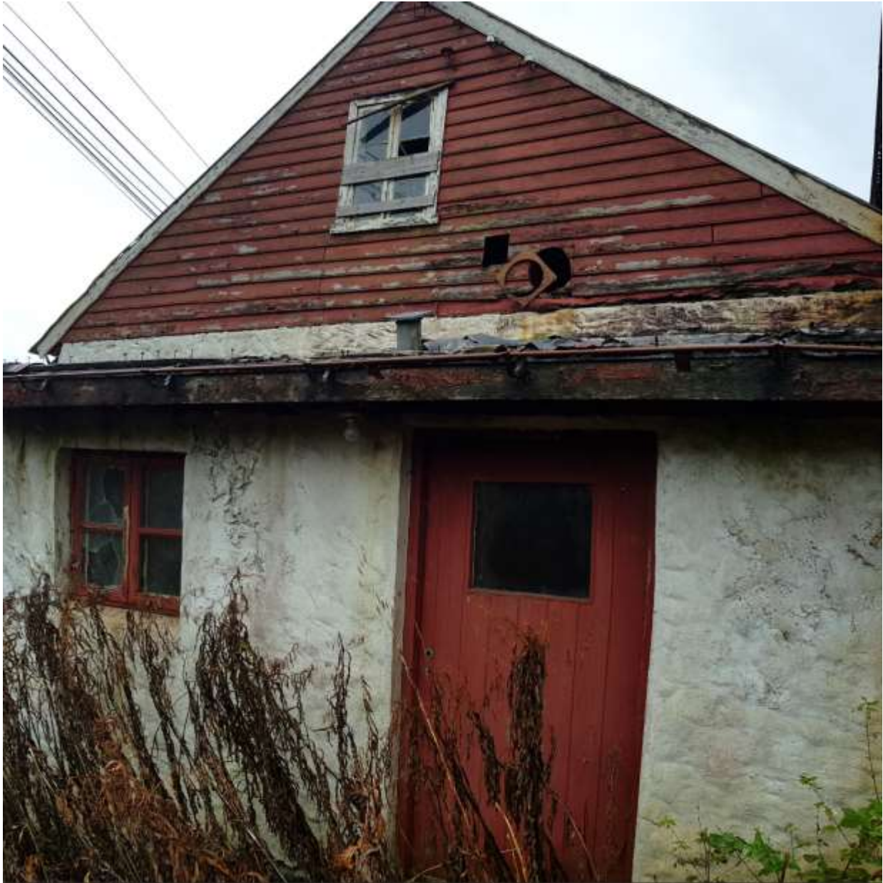
Figur 48: Driftsbygningen har bevart flere eldre vindu, men de er i dårlig stand. Her på nordveggen.
