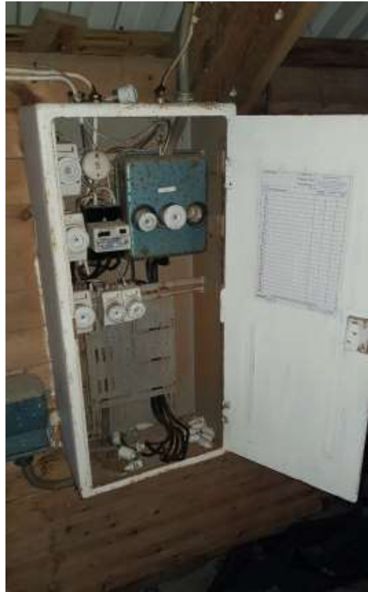
Figur 58: Detalj, sikringsskap i fjøset i vest.
