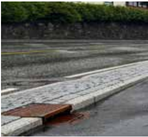
Fig 47 Kjeftesluk i støpejern integrert i refuge
