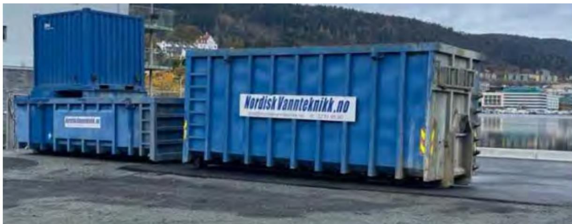
Figur 5 Vannrensaneanlegget levert av Nordisk Vannteknikk AS (fra OceanFront AS, 2023; vedlegg 1)
