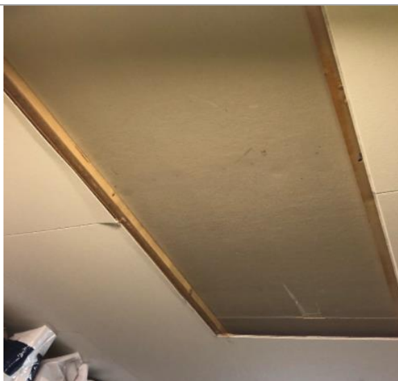
Bilde 8: Asbestolux-plater over nedlektet himling
