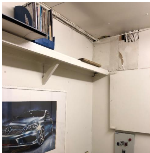
Bilde 6: Asbestoluxplater på kontor (tak og vegg)
