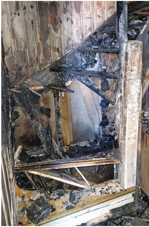
FIGUR 6 TRAPP FRA FØRSTE ETASJE TIL ANDRE ETASJE. BILDET VISER HVOR EN RØYKDYKKER GIKK GJENNOM TRAPPEN
