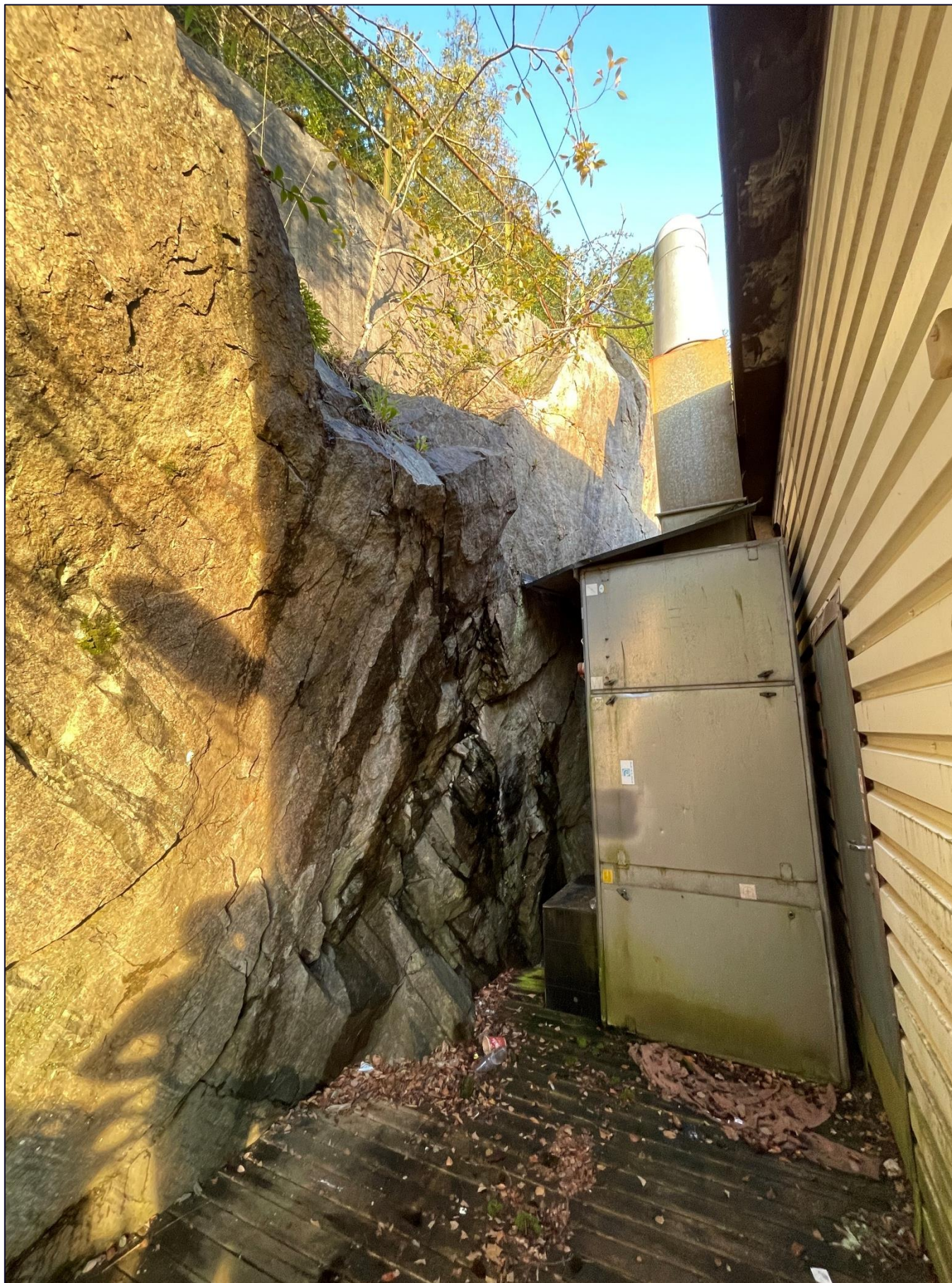
Figur 29 Bilde 9 er tatt like bak den nordligste delen av bygningsmassen på tiltaksområdet, og viser sprekkemønsteret i den massive gneisen. Bilde av Skrið
