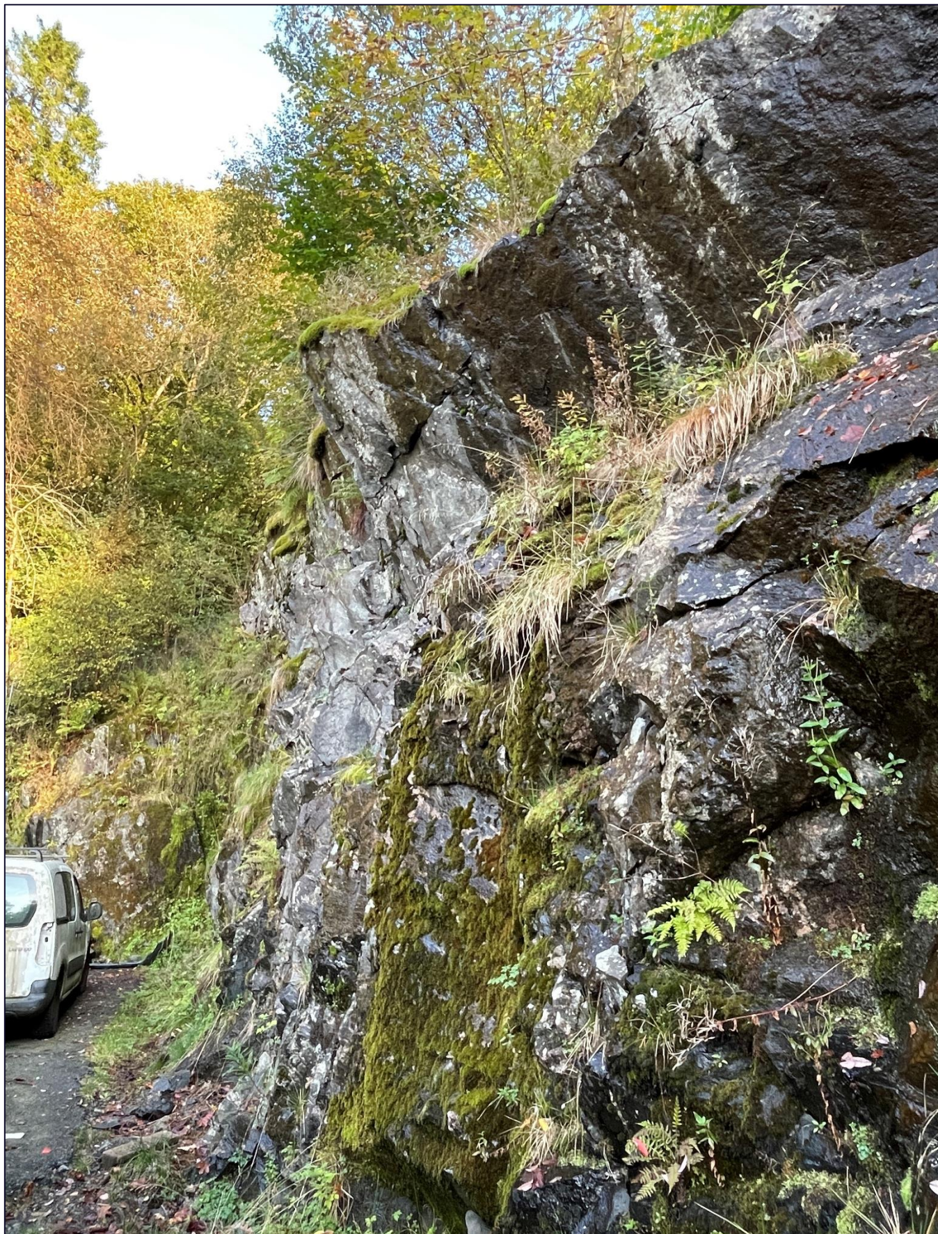
Figur 25 Bilde 5 er tatt mot ØSØ og viser at den steile skrenten med bart fjell i dagen sør i tiltaksområdet også har overheng. Bildet viser også hvordan gneisen med den sterke kaledonske overpregningen er meget oppsprukket i både små og store blokker. Bilde av Skrið
