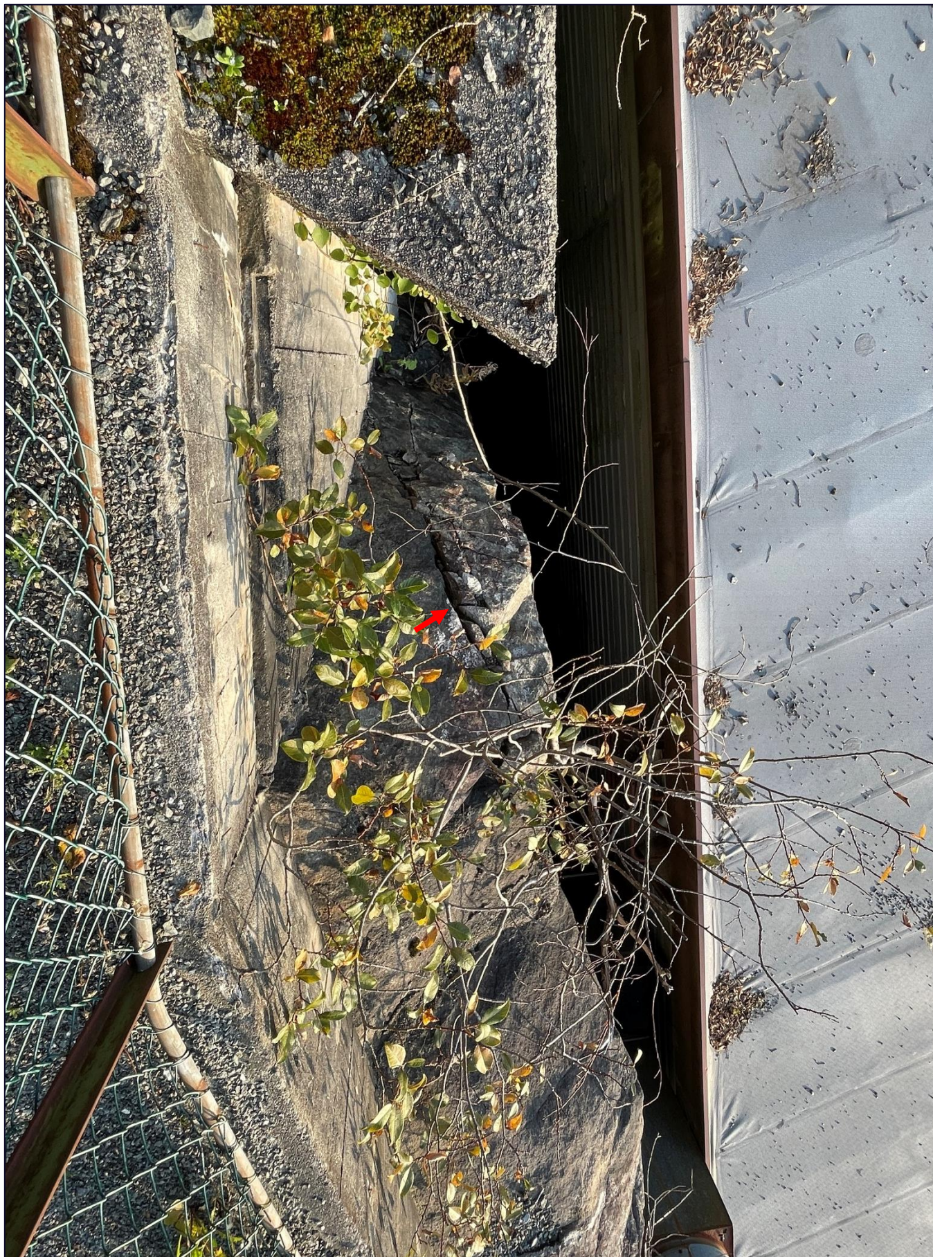
Figur 31 Bilde 11 er tatt ovenfra fra turveien like bak den nordligste delen av bygningsmassen på tiltaksområdet. Bildet viser vertikale sprekker (rød pil) i den massive gneisen som med tid vil utvikle seg til steinsprang av store blokker. Bilde av Skrið
