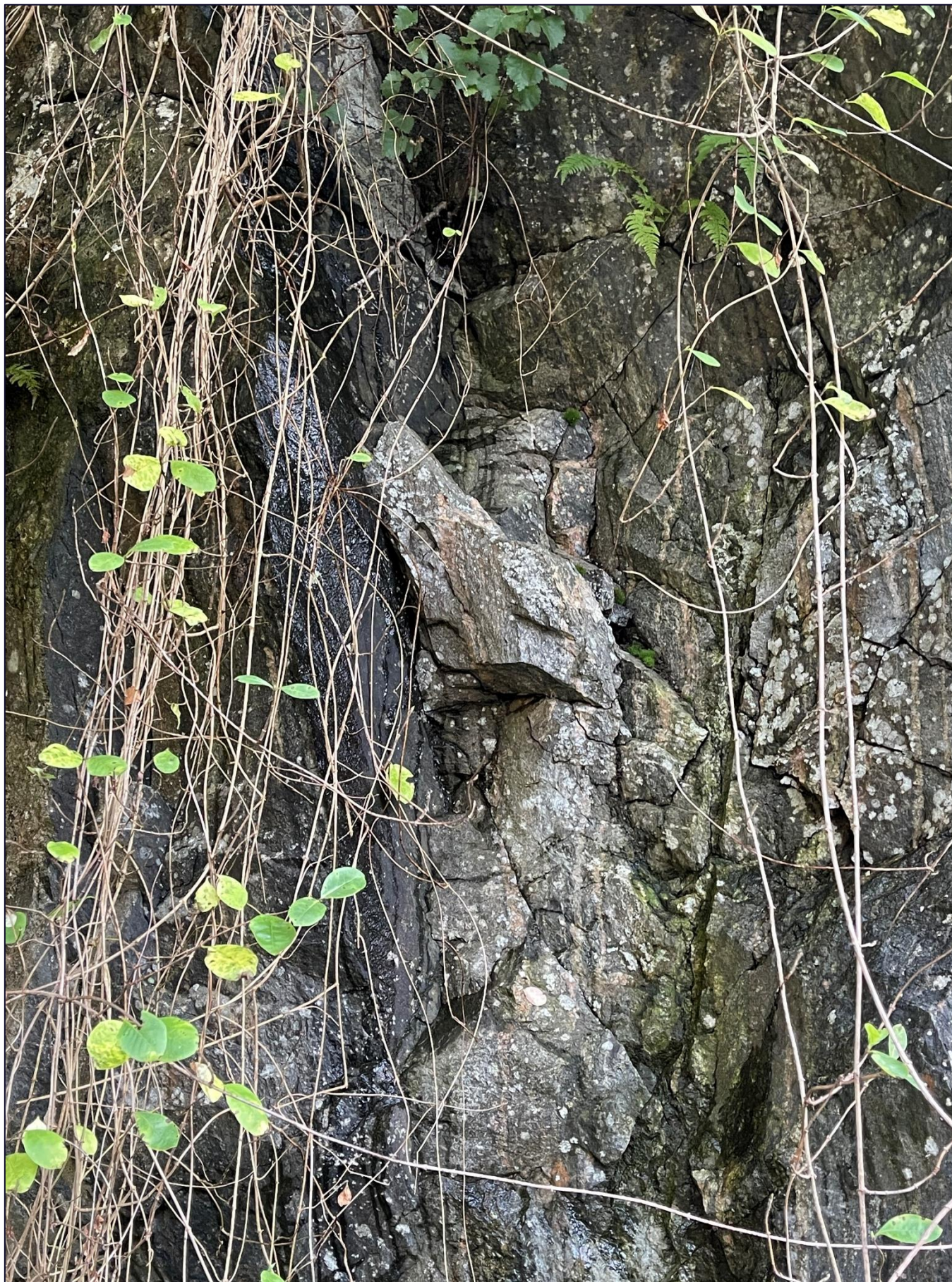
Figur 27 Bilde 7 er nærbilde av den steile fjellskrenten som går langs hele tiltaksområdets sørlige grense. Gneisen med den sterke kaledonske overpregningen er meget oppsprukket, og steinsprang fra denne skrenten kan forventes. Bilde av Skrið
