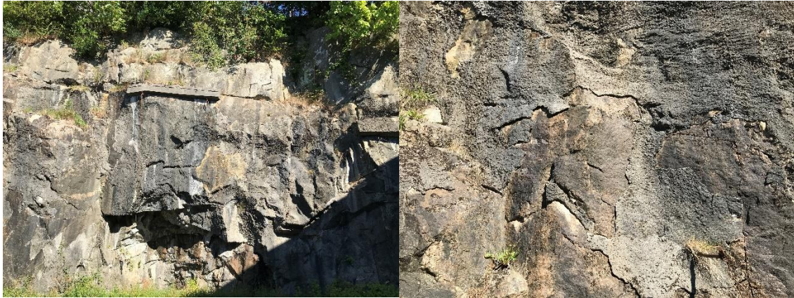
Figur 15: Foto som viser eksempel fra fjellskjæring vest for Hegrenesveien 15D og 15C sikret med sprøytebetong, bolter og sprøytebetong som ikke lenger har tilstrekkelig funksjon.
