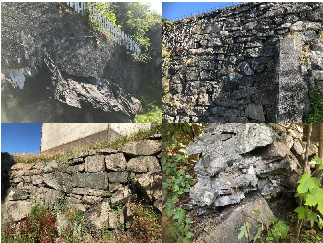
Figur 16: Foto som viser eksempel på ustabile mur konstruksjoner innenfor planområdet (Vedlegg 9).
