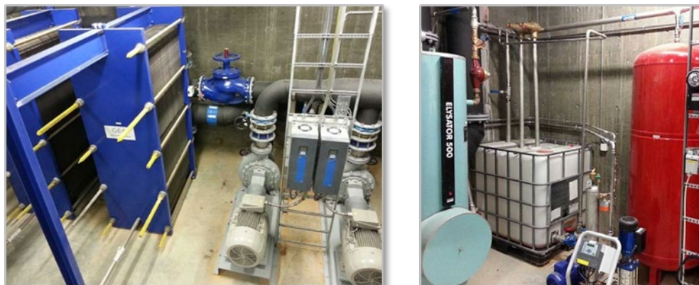
Figur 9: Eksempel Grillstad marina- Trondheim av plasstøpt pumpekum i betong med to platevarmevekslere i titan samt tvillingpumper, væskebehandlingsanlegg og trykkløst system for sekundærkrets med sirkulerende frostvæske (QPS AS, 2020 med et sjøvannanlegg på 3-4 MW).
