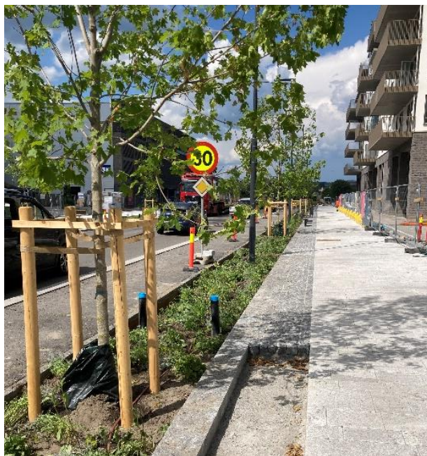
Figur 3. Eksempel på sammenhengende blågrønn struktur/kanal i byområde (ny hovedgate i Lørenskog sentrumsområde under bygging). Grøntkanalen er 1,5 m bred og tar hånd om alt overvann fra sidearealene, også flom. Sidearealene har tverrfall mot kanalen og kanalen har et sammenhengende lengdefall. I Grønnevikken er det en forutsetning av kanalen utformes med tett bunn for å unngå infiltrasjon til forurenset grunn. Trær krever en særskilt løsning for å oppnå tilstrekkelig rotjordvolum kombinert med tett bunn.
