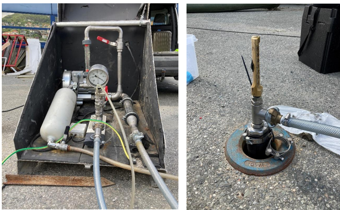
Figur 9 Pumpesystem og tilkobling til brønntopp.
