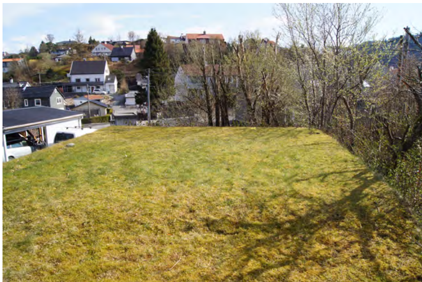
Figur 67. Sætervegen 12D, garasjetak.
