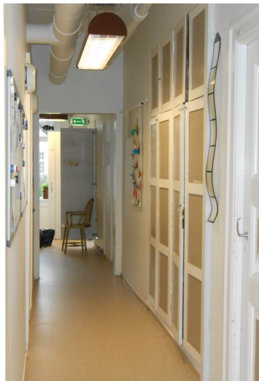
Figur 11. Gang. De fleste overflater, gulv, vegger, dører, tak er nye. Noen dørblader og andre detaljer er originale (Foto: Byantikvaren 2015).
