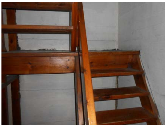
Figur 28. Trappen i slangetårnet er bratt og enkelt utført (Foto: Bergen kommune, Byantikvaren 2015).
