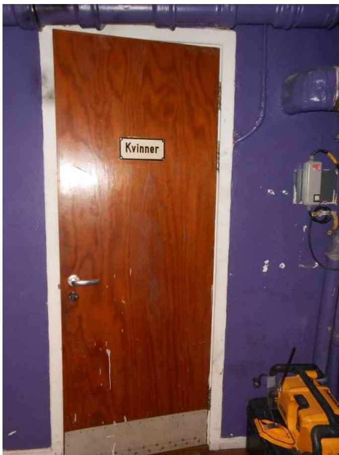
Figur 27. Én av få gamle dører i bygningen, her fra kjelleretasjen (Foto: Bergen kommune, Byantikvaren 2015).
