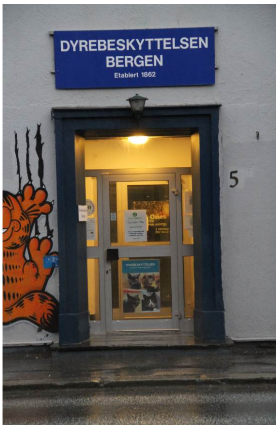
Figur 21: Inngangsparti fra Jekteviken. Døren er skiftet, men portalen og «smyget» er opprinnelig (Foto: Byantikvaren, 2015).
