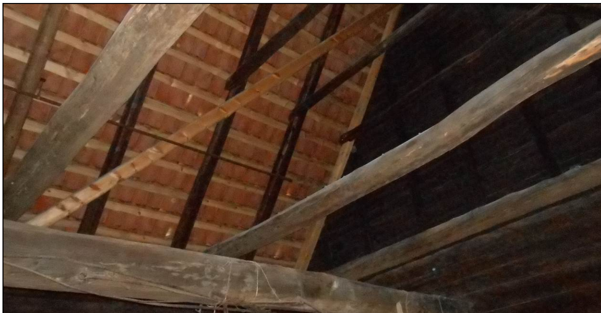
Figur 7: Dramshusens ildhus. Her er teglsteinen lagt på uten undertak, slik at en ser direkte opp i taksteinen. Hele Dramshusen er i én etasje, men skjøtstuen er delt av med gulv mot loftet (Foto: Byantikvaren 2015).
