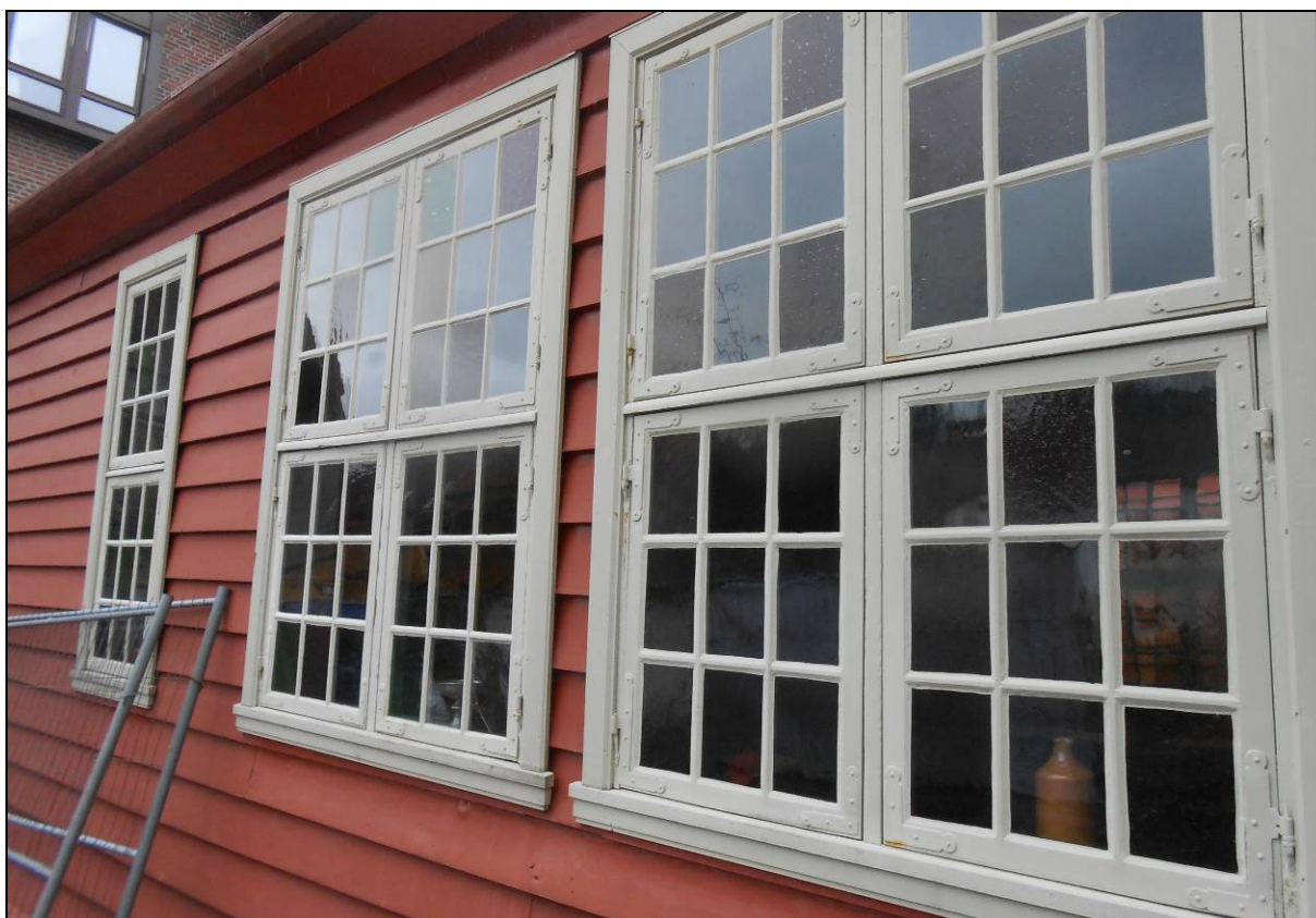
Figur 14: Barokkvinduene i Dramshusen er ikke opprinnelige fra 1700 tallet, men kopier av en historisk vindustype og laget på 1930- eller 40-tallet (Foto: Byantikvaren 2015).
