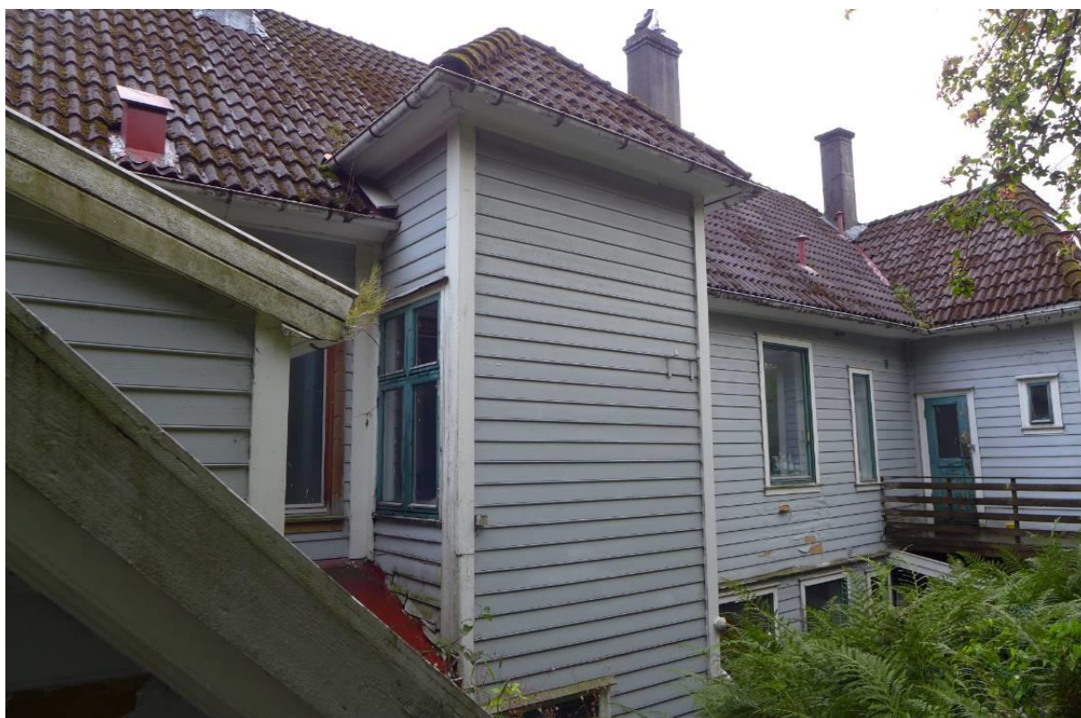
Figur 10: Nordøstfasaden mot hagen ligger med høye steinmurer nesten helt inntil husveggen, men har utgang til hagesiden helt fra kjellerplan via utvendige trapper. Det er tre utbygg på baksiden, i midten ser vi trappehuset der hovedtrappen ligger.
