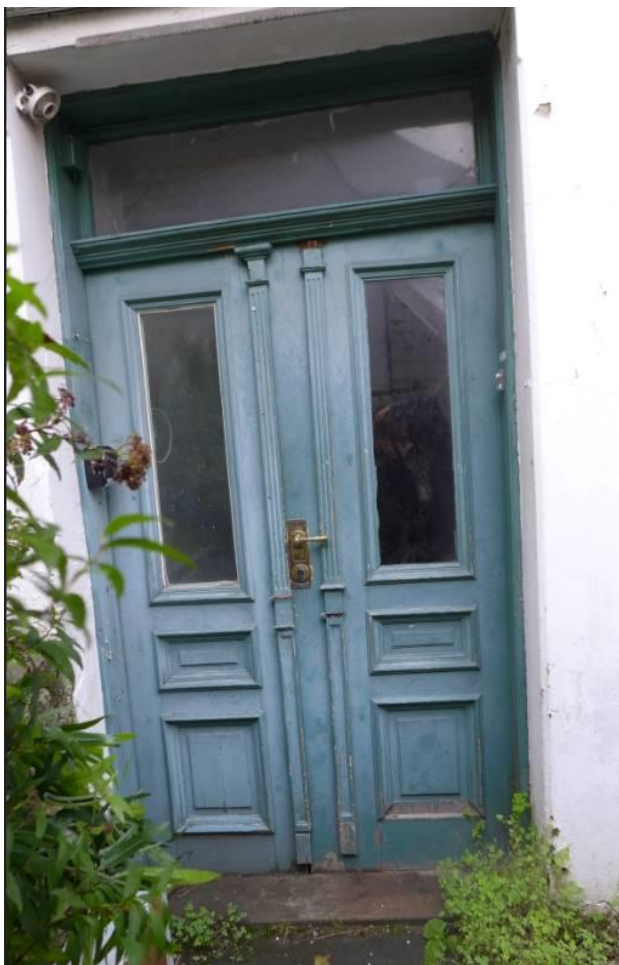
Figur 16: Inngangsdøren i nordenden/til venstre på hovedfasaden er fra 1800-tallet. Den er i sveitserstil, med to høysmale dørblad, glass i øverste dørspill og overlysvindu. De utskårne detaljene i døren som er borte/råteskadet, bør restaureres/kopieres.
