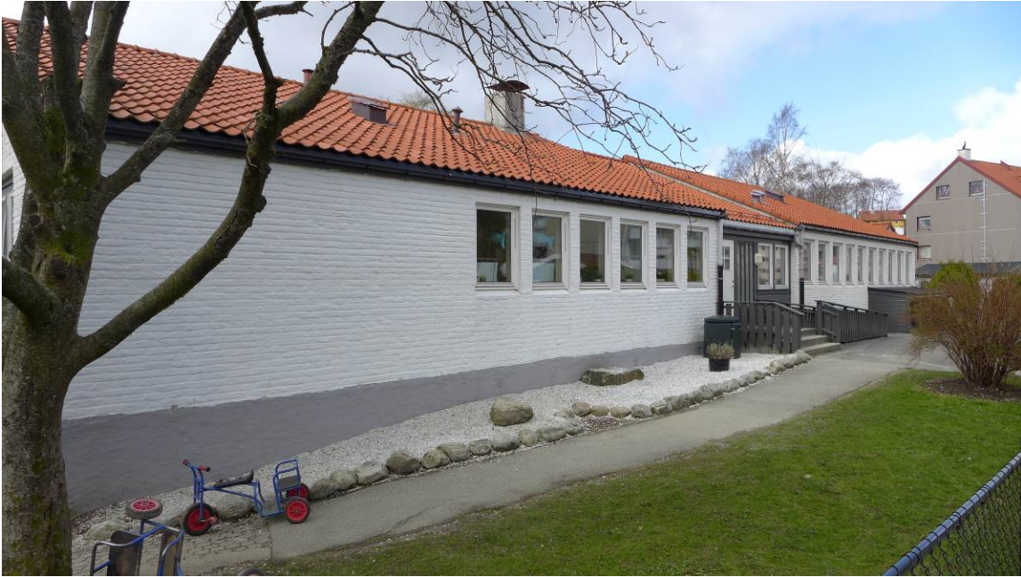
Figur 6: Fasadene er langstrakte med vinduene som horisontale bånd. Mursteinsfasadene er slemmet (Byantikvaren 2015).
