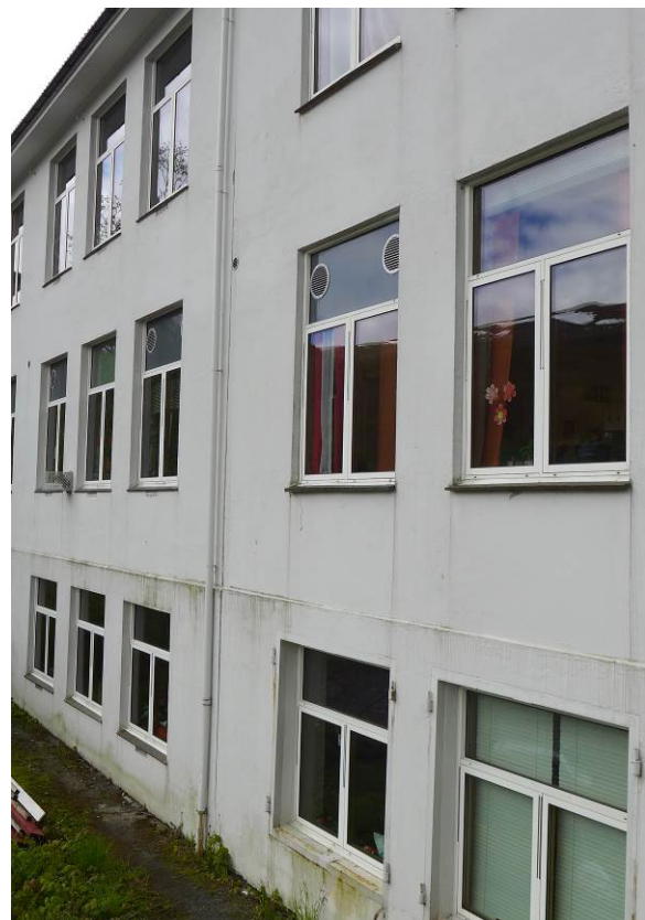
Figur 9: Nye vindu i byggets vestfasade. Vinduene har karmmer av tre på innsiden, men er kledd med aluminium på utsiden (Foto: Bergen kommune, Byantikvaren 2015).
