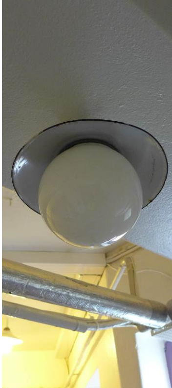
Figur 20: Eksempel på bevart taklampe i kjelleren (Foto: Bergen kommune, Byantikvaren 2015).
