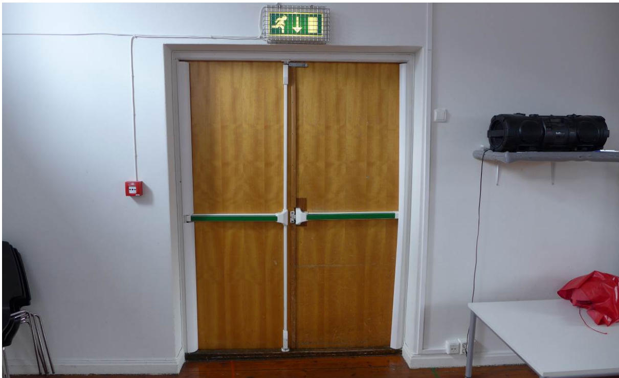
Figur 23: Gammel dør inn til gymsal. Døren har i nyere tid blitt tilpasset i henhold til krav til rømningsvei (Foto: Bergen kommune, Byantikvaren 2015).
