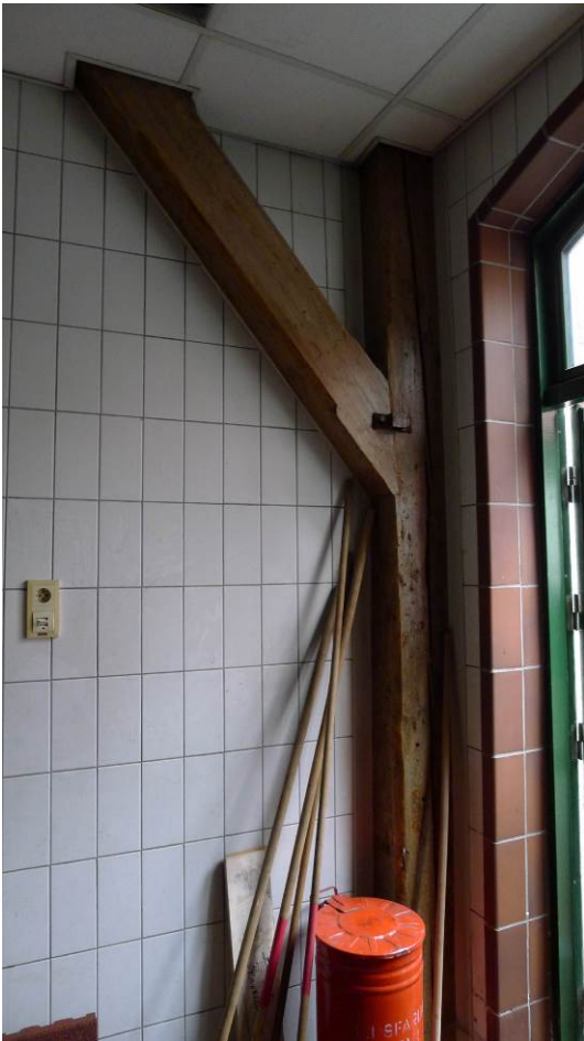
Figur 13. Bærestolpe i garasje (Foto: Byantikvaren, Bergen kommune 2015).
