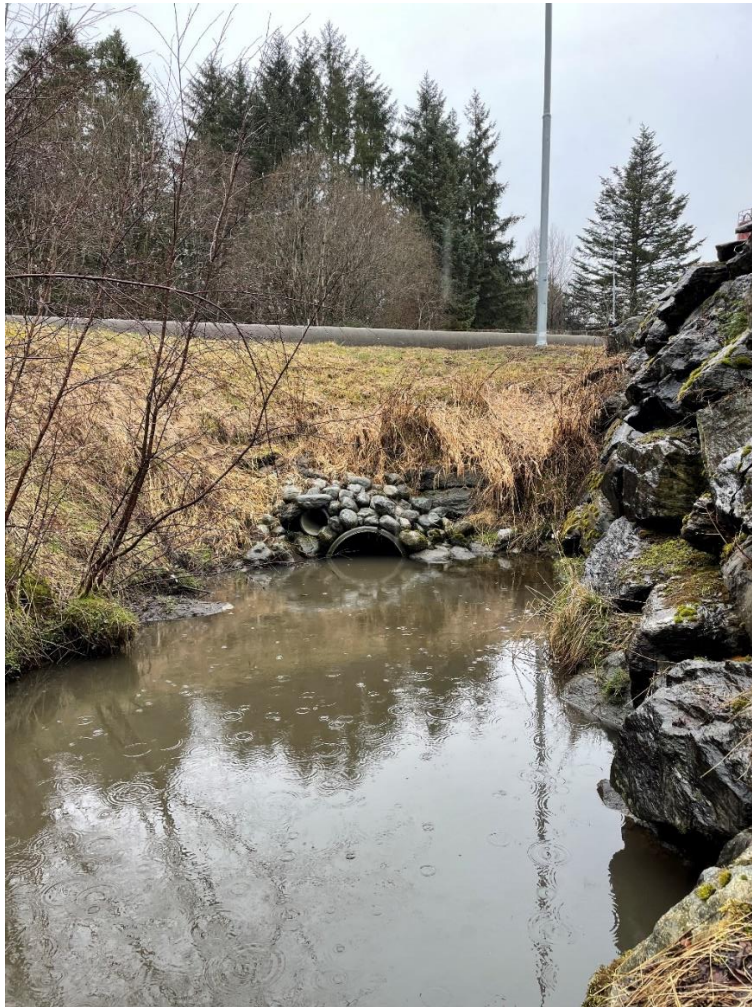
Figur 3-1: Bilde viser stikkrennen, som består av to plastrør
