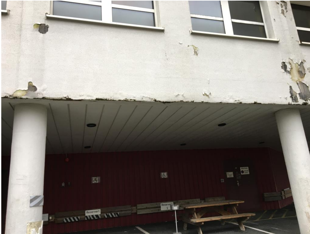
Figur 45. Søylar som bærekonstruksjon med fuktskader
