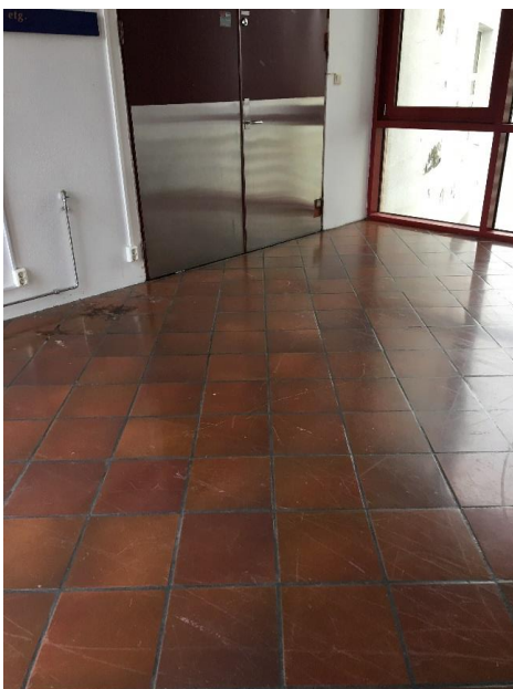
Figur 46. Slitasje flisegulv i mellombygg
