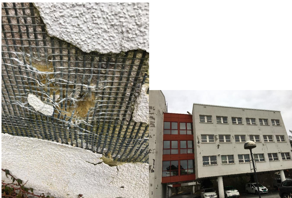
Figur 48. Der er fuktskade inn i isolasjon bak fasadepuss.
