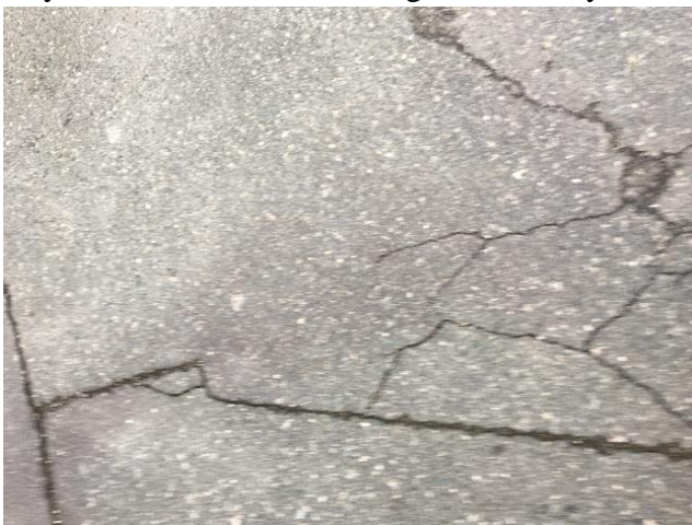
Figur 44. Setninger i asfalt.
