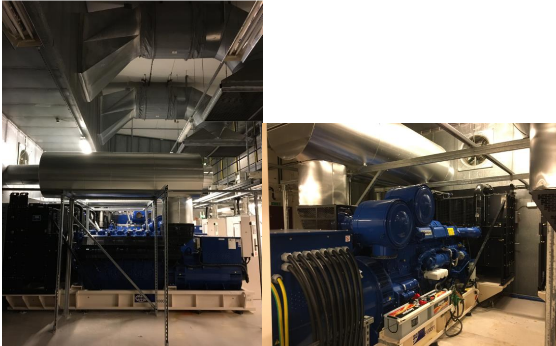
Figur 43. Bilde av nødaggregater.
