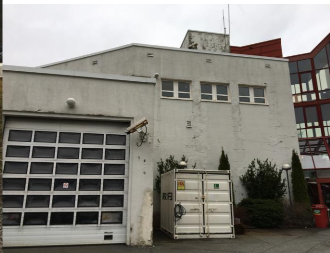
Figur 51. Fuktskader etter avrenning fra tak
