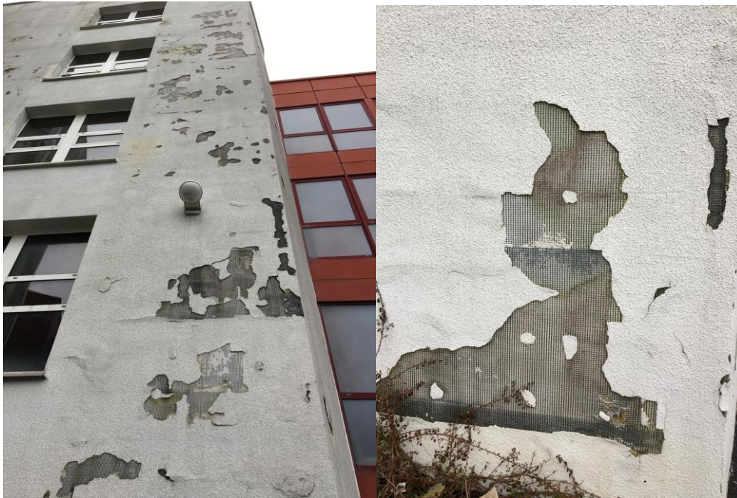
Figur 27. Bilder av fasade/ yttervegger og skader på puss.
