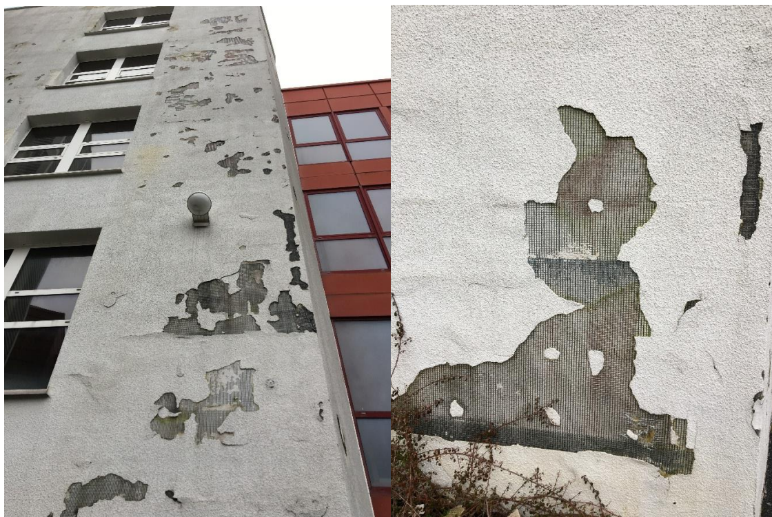
Figur 47. Skade på fasadepuss som flasser av fibernet.
