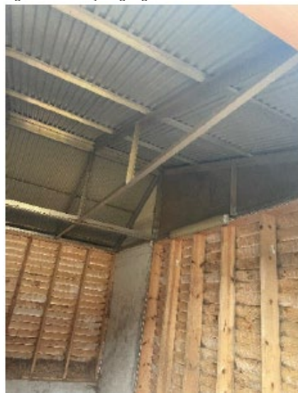
Figur 17 - Fagverksbjelker og fyrkjel i teknisk rom.
