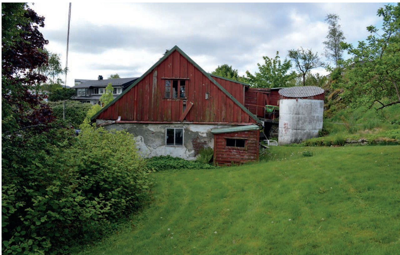
Fasade mot nord, vindauga øvst på veggen er truleg originalt. Kledningen er ikkje original, og i noko dårleg stand.
