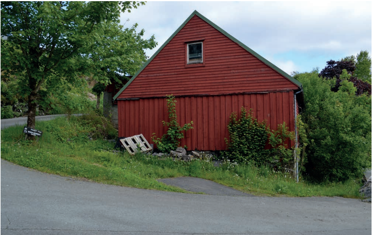
Fasade mot sør er i grei stand, men bordkledning er ikkje original.
