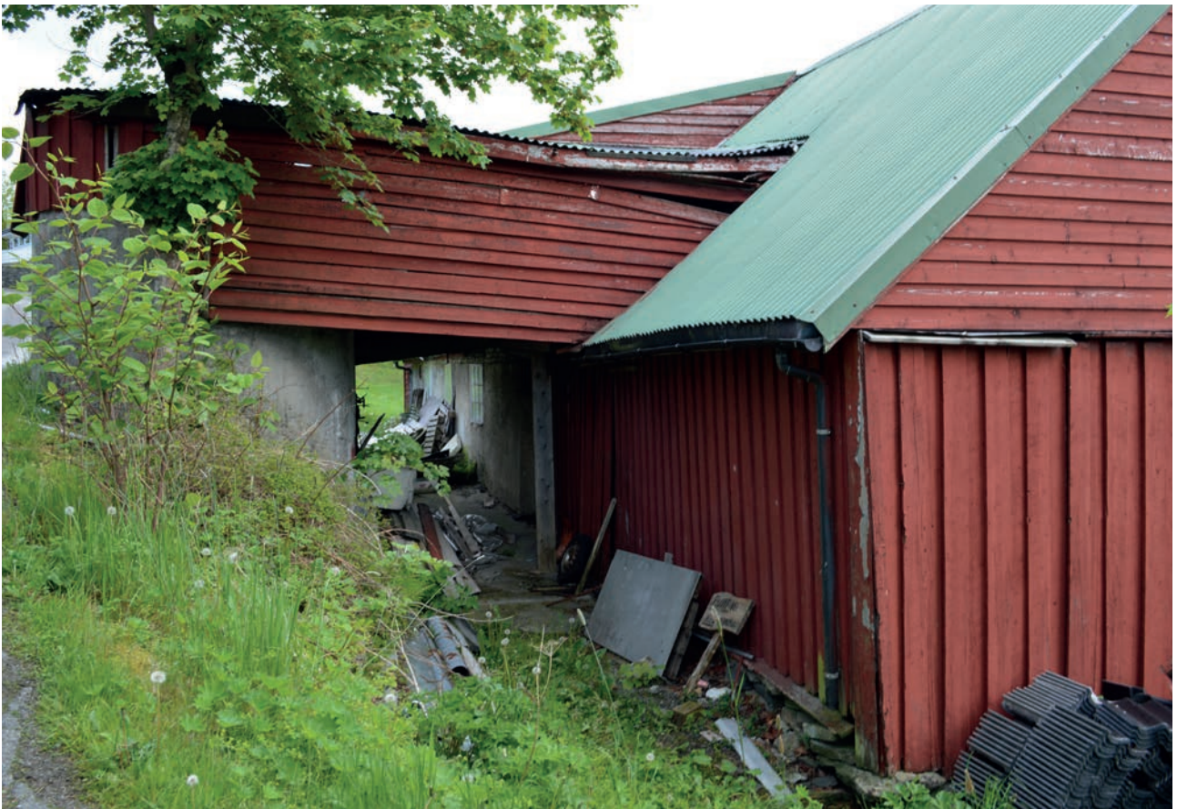
Delar av fasade mot vest og sør. Her ser ein den eine siloen lengst mot sør. Det er uvisst når denne blei sett opp. Kledning treng reparasjon.
