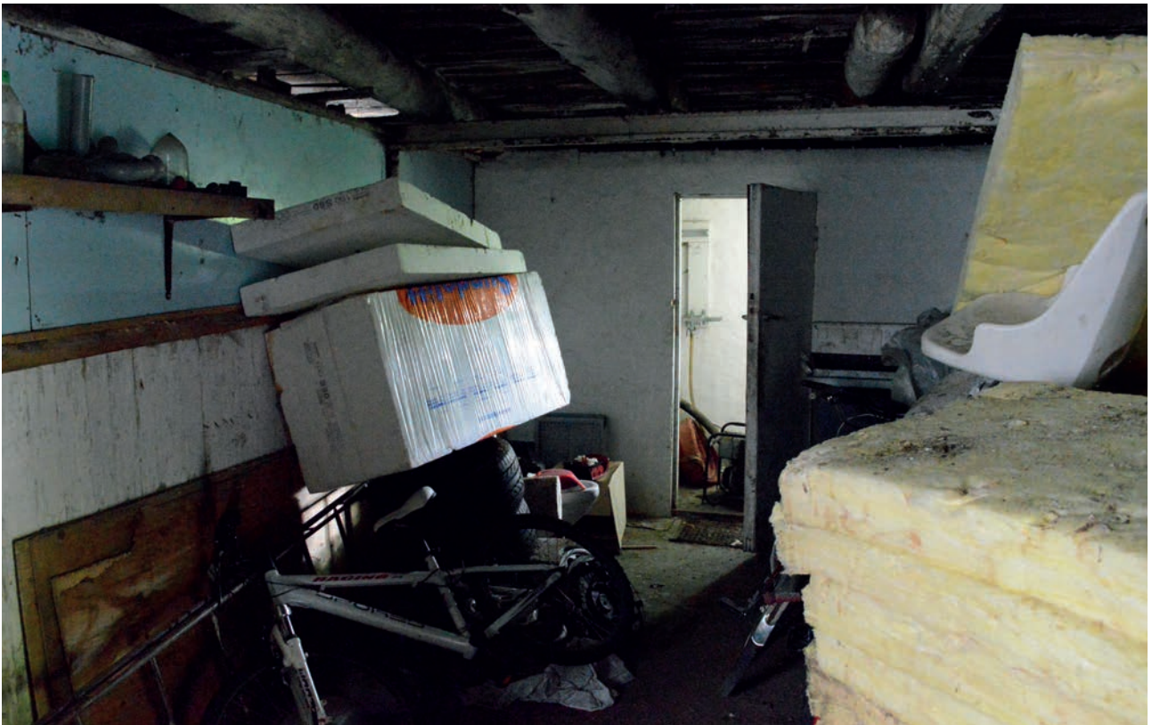
Kjellaretasjen, nord i bygget. Her ser ein etasjeskilje i originale bjelkar og bord, forsterka med ståldragarar. Det er prega av betydeleg fukt og råte.
