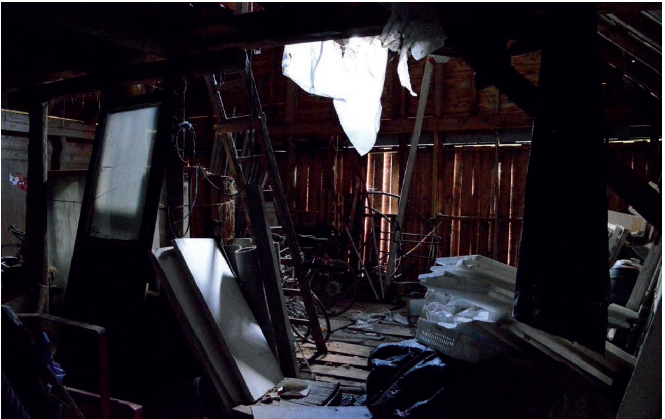
Andre etasje mot sør, tidlegare høybrot. Golvet er i dårleg stand, og det er ikkje lenger trygt å gå på det. Her er særst få detaljar igjen frå det som ein gong har vore ei grindløe. Ut i frå materialbruk og konstruksjon kan ein sjå at det har vore utført større endringar over fleire omgangar opp igjennom åra.
