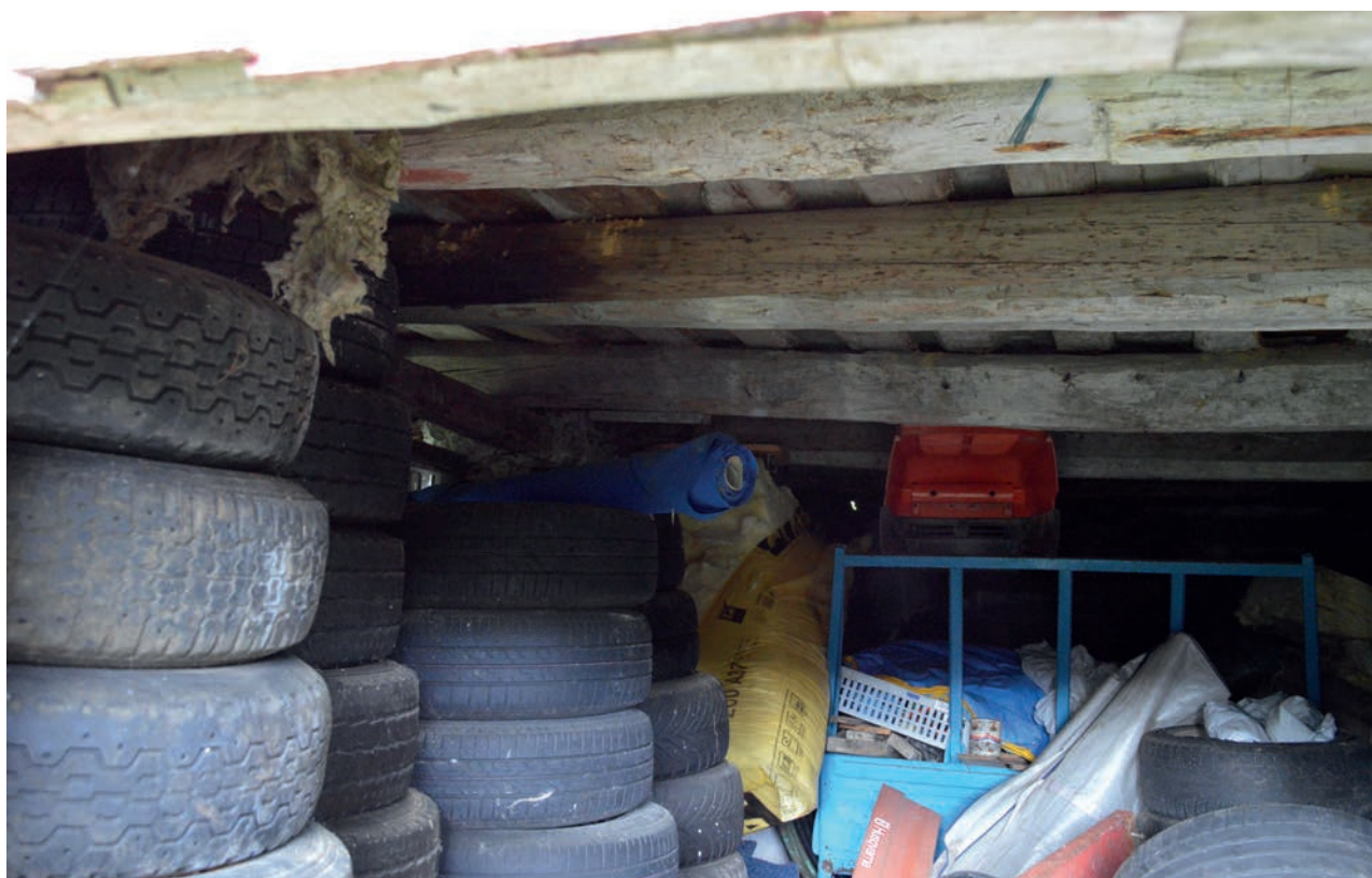
Frå kjellaretasje, mot sør. Originalt bjelkelag. I denne delen er det lite fukt og rote.
