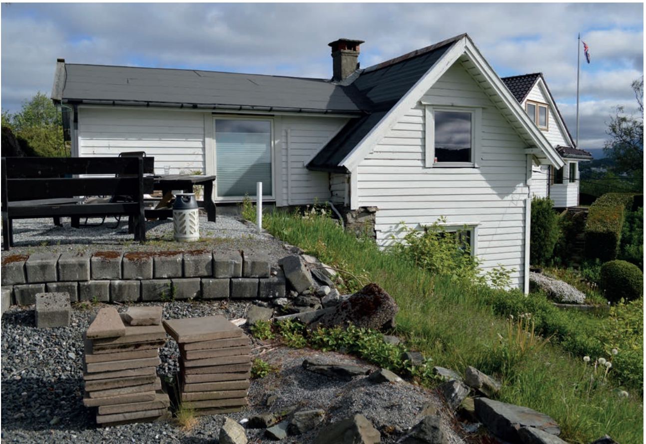
Fasade mot sør, her ser ein gavlvegg og tilbygget frå 1980-åra mot vest. Her ser ein også at taket på denne sida ikkje lenger har skiferheller.
