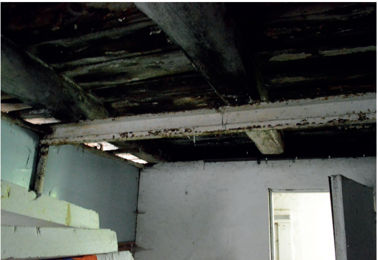
Nærbilde av etasjeskilje. Her ser ein at både bjelkar og bord er prega av fuktskadar.
